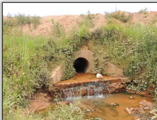
Figura 534. Jusante do BSTC com leito úmido (junho de 2014). Ponto 05_Lote 01-A Coord. UTM 22M SAD 69 E- 672938 /N-9440146
