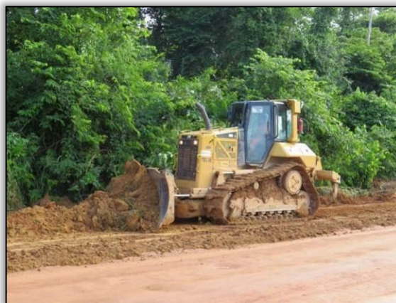
Figura 44. Acompanhamento de limpeza de pista no trecho entre as cidades de Placas e Rurópolis – Lote 03-B. Data: 23/03/2015 Coord. UTM 21M SAD 69 E-0768439/N-9565546
