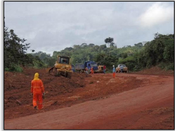
Figura 38. Acompanhamento de manutenção de traçado entre Placas e Rurópolis – Lote 03-B. Data: 13/03/2015 Coord. UTM 21M SAD 69 E-0762559/N-9563453
