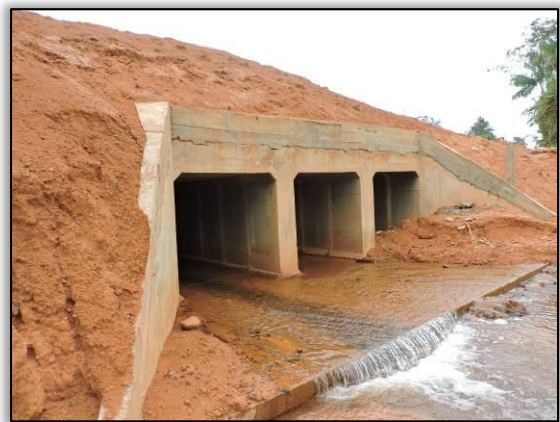
Figura 542. Jusante do BTCC com leito úmido em condições normais de NA (janeiro de 2015). Ponto 07 - local I _ Lote 01-A Coord. UTM 22M SAD 69 E- 669455 /N-9455313
