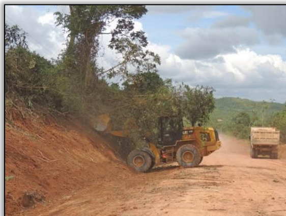
Figura 20. Supressão vegetal e limpeza lateral no trecho entre Uruará e Placas – Lote 02-B.
