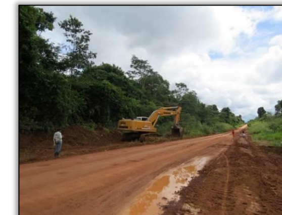
Figura 48. Vistoria de área de limpeza lateral entre Placas e Rurópolis – Lote 03-B. Data: 26/03/2015 Coord. UTM 22M SAD 69 E-0770011/N-9566089
