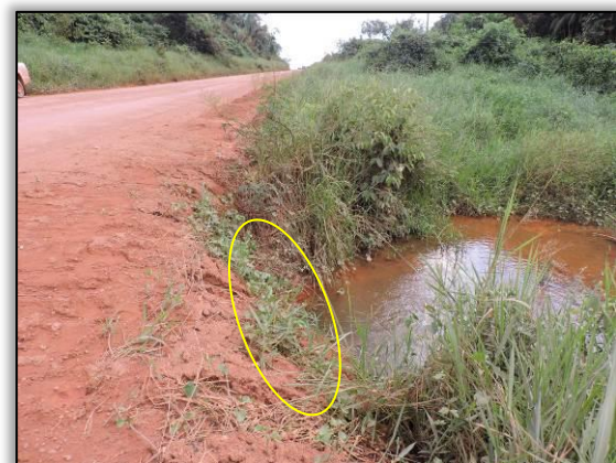
Figura 570. Boca do BSCC à jusante maio de 2015). Ponto 54 _ Lote 01-B Coord. UTM 22M SAD 69 E-243266/N-9600241
