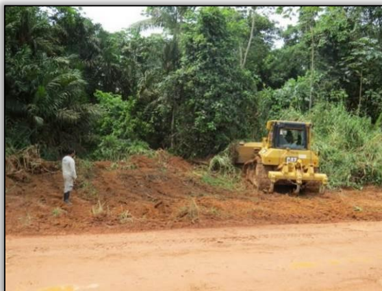
Figura 41. Acompanhamento de limpeza lateral entre as cidades de Placas e Rurópolis – Lote 03-B. Data: 18/03/2015 Coord. UTM 21M SAD 69 E-0767242/N-9565128
