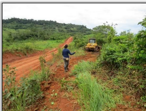
Figura 27. Acompanhamento de limpeza lateral no trecho entre Uruará e Placas – Lote 02-B.
