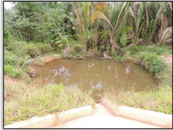
Figura 589. Água represada na saída da OAC (outubro de 2014). Ponto 76 Lote 02-A Coord. UTM 22M SAD 69 E-604592/N-9538664
