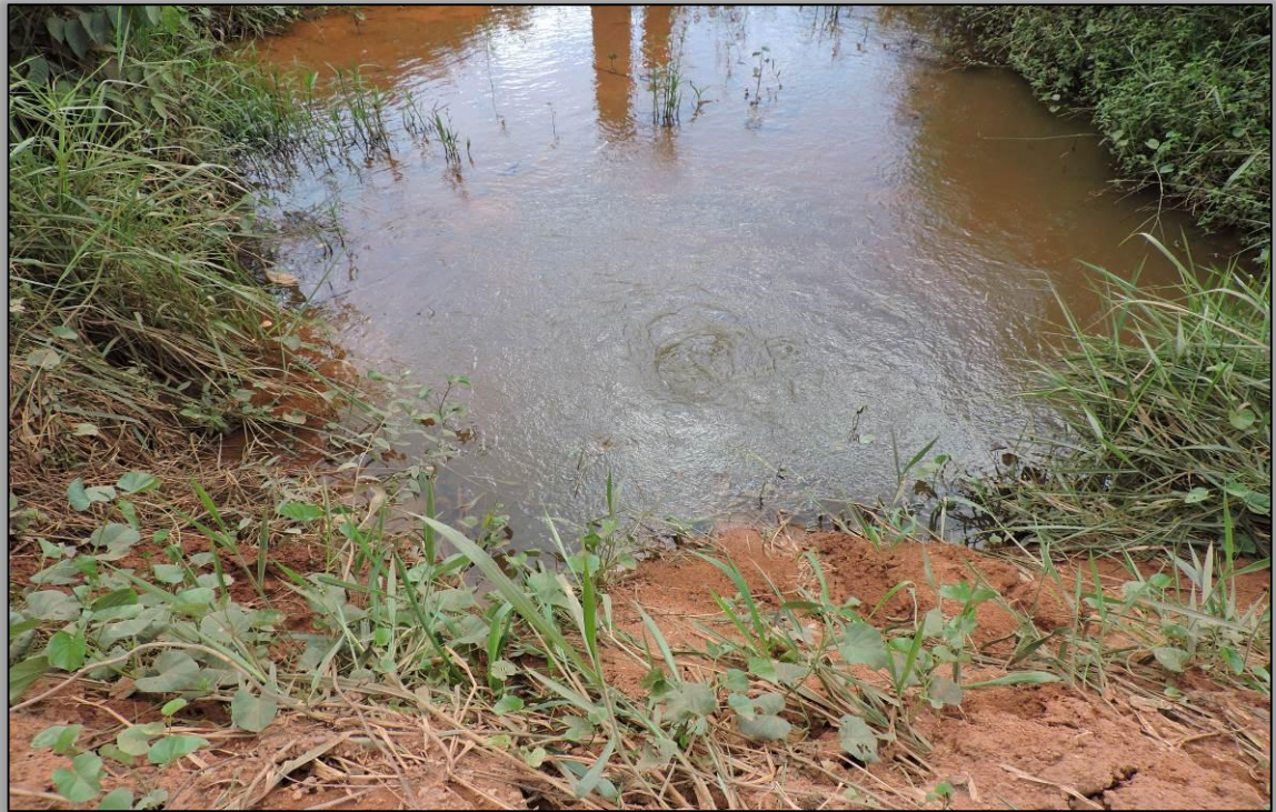
Figura 571. Saída da OAC obstruída com solo (Jusante). Ponto 54 _ Lote 01-B Coord. UTM 22M SAD 69 E-243266/N-9600241
