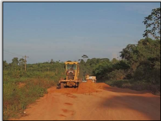
Figura 16. Acompanhamento de manutenção de pista entre Medicilândia e Uruará – Lote 01-B. Data: 07/02/2015 Coord. UTM 22M SAD 69 E-0206212/N-9590398
