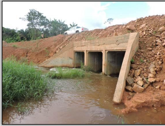
Figura 539. Montante do BTCC com leito úmido após chuva intensa (maio de 2015) Ponto 07 - local I _ Lote 01-A Coord. UTM 22M SAD 69 E- 669455 /N-9455313
