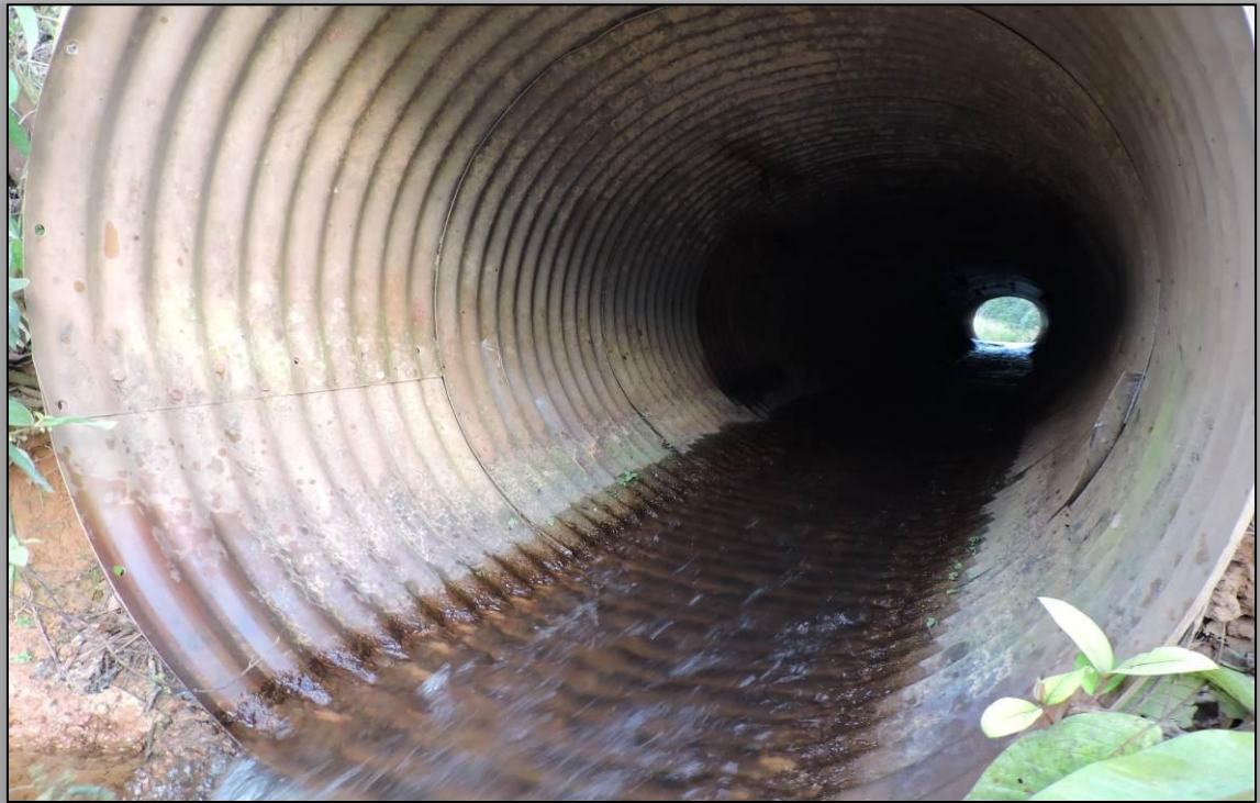
Figura 574. Nível de água no interior do BTCC (maio de 2015). Ponto 62 _ Lote 03-B Coord. UTM 21M SAD 69 E-769356/N-9565882
