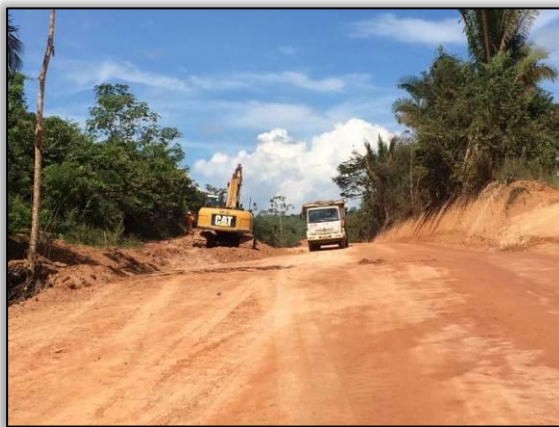
Figura 89. Acompanhamento de terraplenagem no trecho entre Cajazeiras e Novo Repartimento – Lote 01-A. Data: 26/05/2015 Coord. UTM 22M SAD 69 E-0659691/N-9467302
