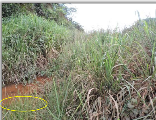
Figura 569. Boca do BSCC à montante (maio de 2015). Ponto 54 _ Lote 01-B Coord. UTM 22M SAD 69 E-243266/N-9600241
