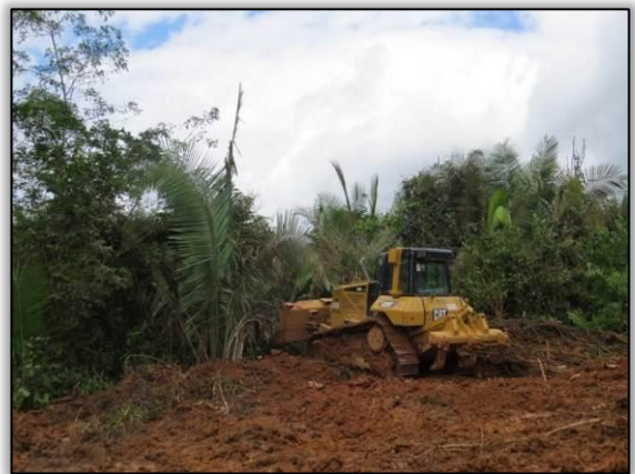
Figura 66. Acompanhamento de limpeza lateral na faixa de domínio entre Uruará e Placas – Lote 02-B. Data: 04/05/2015 Coord. UTM 22M SAD 69 E-0173696/N-9576993
