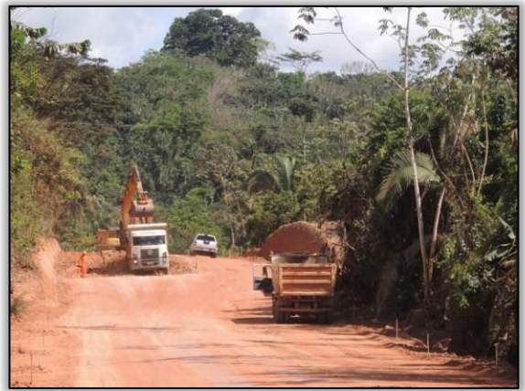
Figura 88. Acompanhamento de terraplenagem entre Cajazeiras e Novo Repartimento – Lote 01-A. Data: 25/05/2015 Coord. UTM 22M SAD 69 E-0660030/N-9467120
