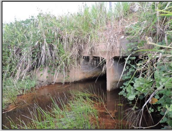
Figura 561. Boca do BDCC a jusante (maio de 2015). Ponto 38 _ Lote 03-A Coord. UTM 22M SAD 69 E-484080/N-9610099
