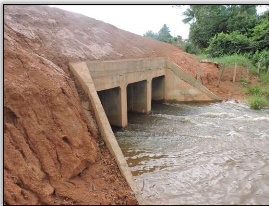
Figura 541. Jusante do BTCC com leito úmido após chuva intensa (maio de 2015). Ponto 07 - local I _ Lote 01-A Coord. UTM 22M SAD 69 E- 669455 /N-9455313
