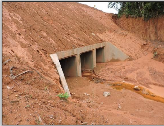
Figura 543. Montante do BTCC (janeiro de 2015). Ponto 07 - local II _ Lote 01-A Coord. UTM 22M SAD 69 E-669054 /N-9455785
