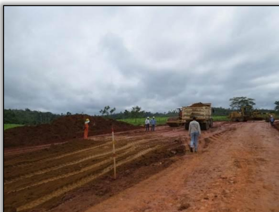
Figura 53. Acompanhamento de atividade de terraplenagem entre Placas e Rurópolis – Lote 03-B. Data: 07/04/2015 Coord. UTM 21M SAD 69 E-0772427/N-9567249
