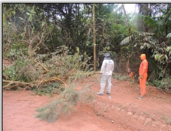
Figura 78. Vistoria de área de supressão vegetal entre Cajazeiras e Novo Repartimento – Lote 01-A. Data: 15/05/2015 Coord. UTM 22M SAD 69 E-0659458/N-9467516
