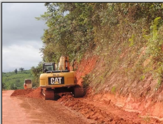
Figura 71. Acompanhamento de limpeza de talude entre Cajazeiras e Novo Repartimento – Lote 01-A. Data: 07/05/2015 Coord. UTM 22M SAD 69 E-0660325/N-9467026
