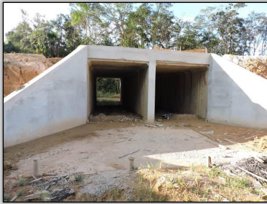
Figura 581. BDCC, montante (maio de 2015). Ponto 68 – local II _ Lote 03-B Coord. UTM 21M SAD 69 E-792303/N-9570341
