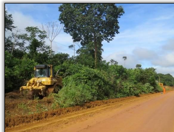
Figura 47. Acompanhamento de limpeza lateral entre Placas e Rurópolis – Lote 03-B. Data: 26/03/2015 Coord. UTM 22M SAD 69 E-770230/N-9566144
