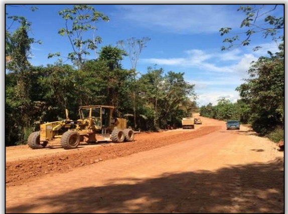
Figura 90. Acompanhamento de atividade de terraplenagem no trecho entre Cajazeiras e Novo Repartimento – Lote 01-A. Data: 26/05/2015 Coord. UTM 22M SAD 69 E-0659481/N-9467502
