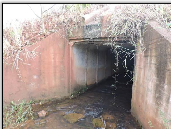
Figura 586. BSCC, montante (maio de 2015). Ponto 76 _ Lote 02-A Coord. UTM 22M SAD 69 E-604592/N-9538664
