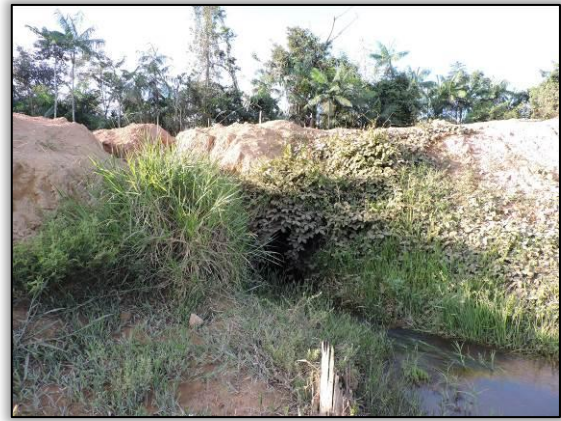
Figura 582. Bueiro ARMCO (Março de 2015). Ponto 68 – local II _ Lote 03-B Coord. UTM 21M SAD 69 E-792303/N-9570341
