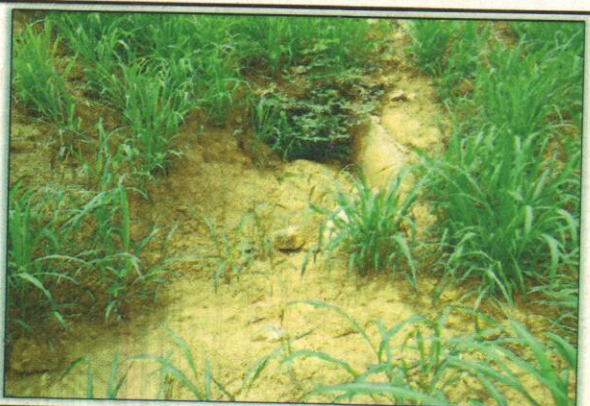
Foto 03 - Bueiro obstruído. Lado Esquerdo
