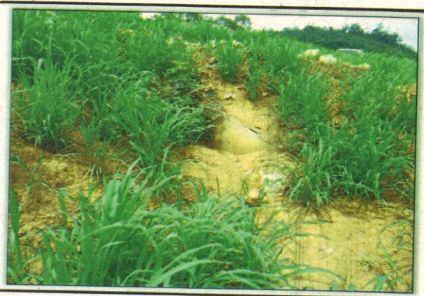
Foto 04- Bueiro Obstruído. Lado Esquerdo
