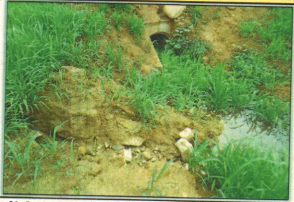
Foto 01 -Bueiro Obstruído. Lado Direito
