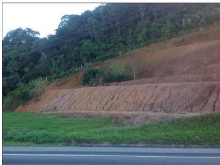
Figura 5 - Exemplo de formação de sulcos em talude sem vegetação.
