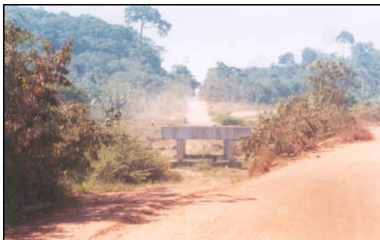
Foto 41 - Ponte em construção sobre o igarapé Jacaré, km. 438, 7. Local com interferências constantes.
