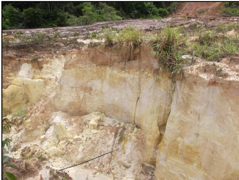
Figura 58 – Cabo óptico da OI em processo erosivo. Coordenada UTM: 20N 829.266E/ 9.710.905N. Data: 28/01/2014. Fonte: Equipe técnica do DNIT.
