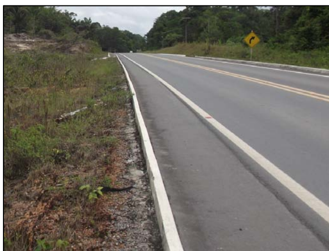
Figura 5 - Segmento da BR-174/AMcom acostamento estreito, de 1 metro. Fonte: Equipe DNIT – Jan/2014.
