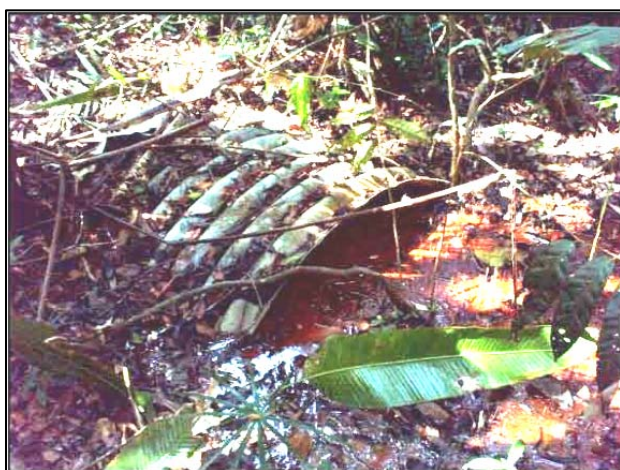
Figura 52 - Bueiro obstruído na BR-174 no Estado do Amazonas. Fotografia obtida de projeto de engenharia.
