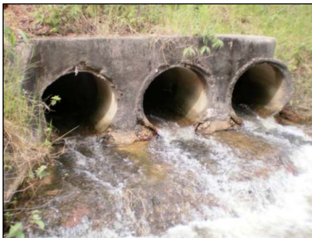
Figura 51 - Bueiro Triplo Tubular em Concreto da BR-174.
