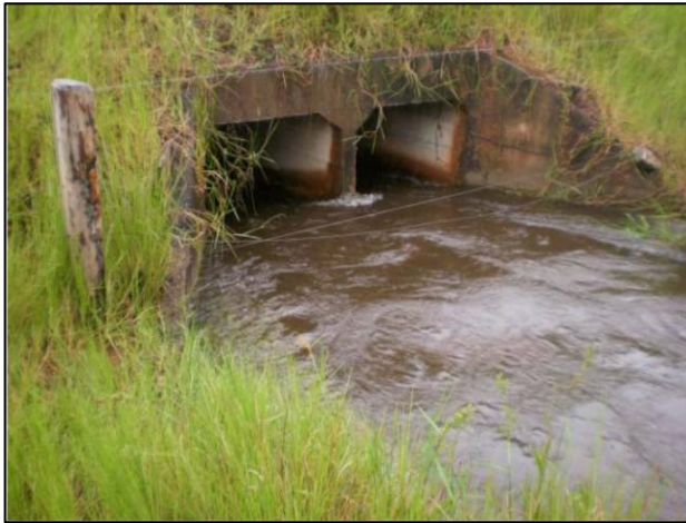
Figura 50 - Bueiro Duplo Celular em Concreto da BR-174.
