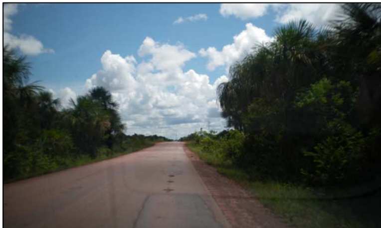
Figura 99 – Trecho da BR-174/RR com buracos e remendos. Fonte: Equipe DNIT – Nov/2013.
