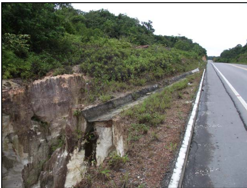
Figura 57 - Voçoroca instalada na canaleta de drenagem da BR-174. Coordenada UTM: 20N 829.802E/ 9.750.486N. Data: 28/01/2014. Fonte: Equipe técnica do DNIT.
