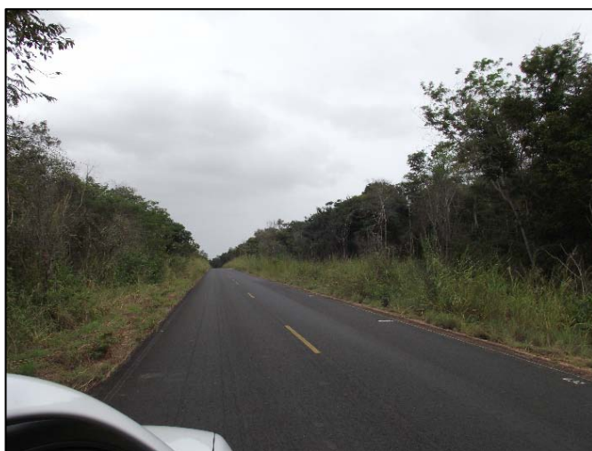
Figura 7 - Segmento da BR-174/RR sem acostamento entre Pacaraima/RR e Boa Vista. Fonte: Equipe DNIT – Nov/2013.
