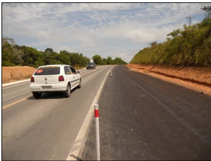
Figura 27 – Segmento da BR-174/AM com implantação em andamento de terceira faixa. Fonte: Equipe DNIT – Nov/2013.
