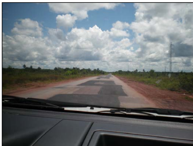
Figura 100 - Trecho da BR-174/RR com remendos. Fonte: Equipe DNIT – Nov/2013.
