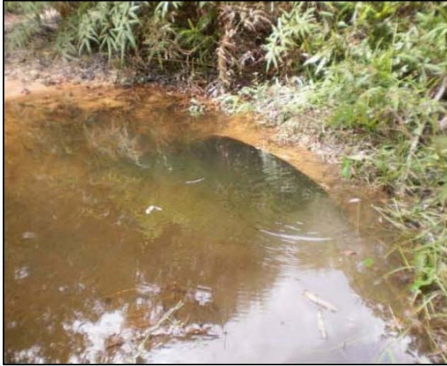
Figura 53 - Bueiro obstruído na BR-174 no Estado do Amazonas. Fotografia obtida de projeto de engenharia.
