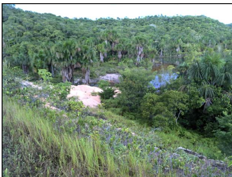
Figura 59 – Processo erosivo mitigado na BR-174. Coordenada UTM: 20M 830.461E/9.716.416N. Data: 28/01/2014. Fonte: Equipe Técnica do DNIT.
