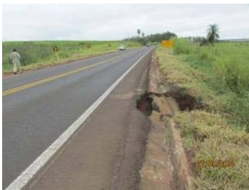
Foto 4.4.b: Processo erosivo na rodovia por deficiência do sistema de drenagem no município de Itaquiraí
