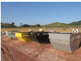
Foto 7.0.b: Exemplo de coleta seletiva de resíduos da construção civil
