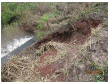
Foto 4.1.c: Processos Erosivos – escorregamento de talude de aterro.
