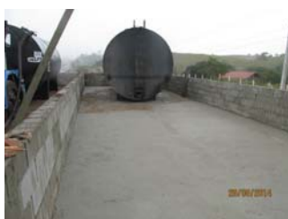
Foto 7.0.d: Controle de produtos perigosos – dique de contenção para evitar contaminação em caso de vazamentos
