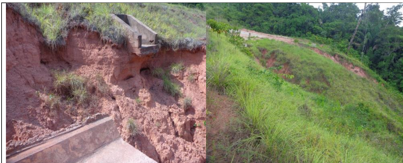
Foto 43 – Ponto 05 - Erosão na saia de aterro e colapso da drenagem superficial. (LD). Coordenada UTM: 0738896-9597788. Data – Dezembro de 2015 Foto 44 – Ponto 05 - Erosões na saia de aterro e colapso da drenagem superficial. (LE). Coordenada UTM: 0738809-9597531. Data – Dezembro de 2015
