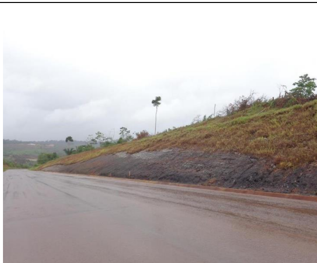
Foto 608 - PAM 91 - Talude sem cobertura vegetal. LE. Data: Fevereiro de 2016.
