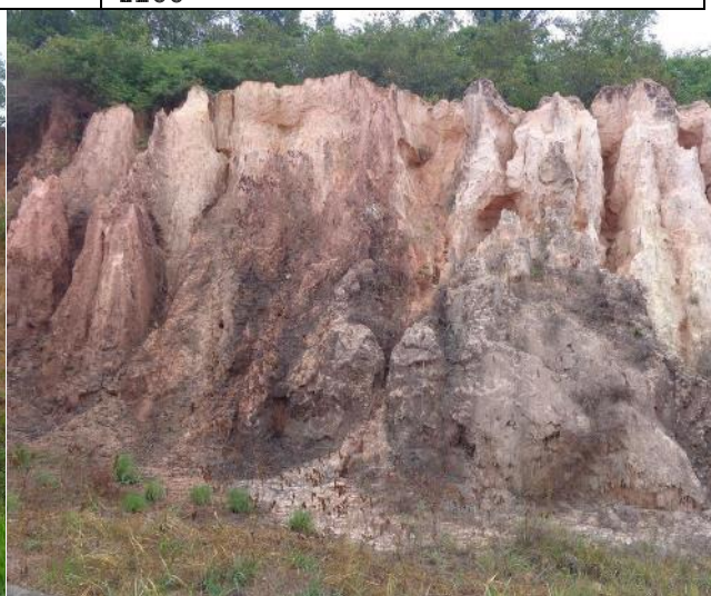
Foto 66 - PAM 79 - Talude exposto com processos erosivos. LD. Data: Janeiro de 2016.
