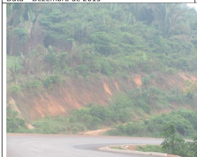
Foto 18 - Ponto 18 Vegetação em desenvolvimento. Face do talude exposto. Coordenada UTM: 623449-9401476. Data - Dezembro de 2015
