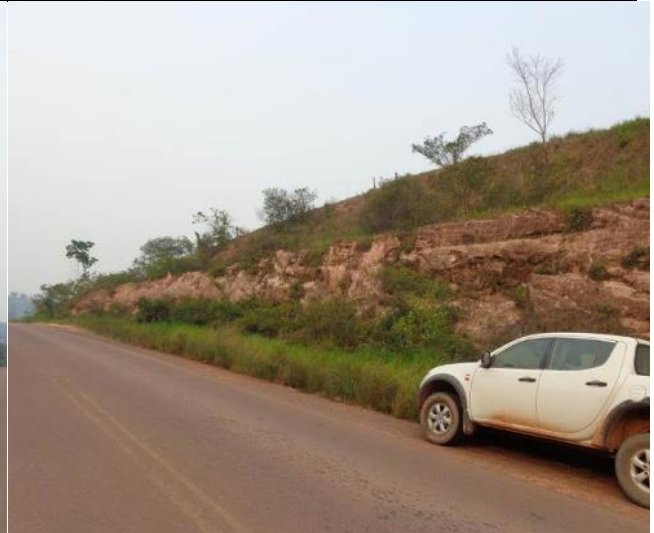
Foto 28 – Ponto 12 - PAM 77 - Talude com processos erosivos (LD). Coordenada UTM: 0634360-9514912. Data – Dezembro de 2015
