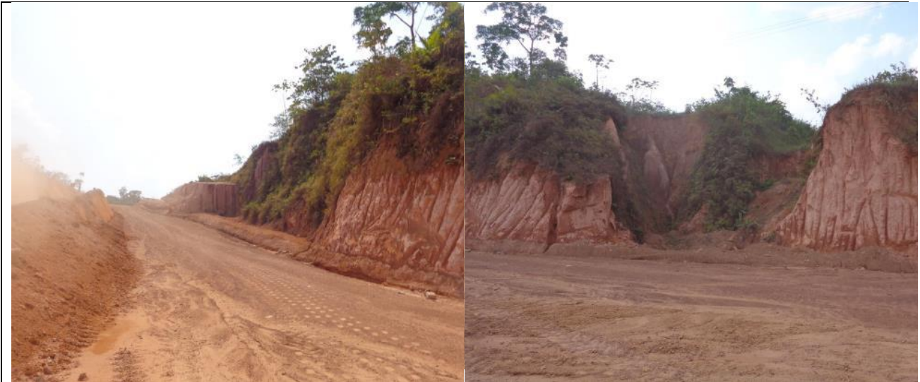
Foto 38 - Ponto 21 - PAM 92 - Tomada geral da área com processos erosivos (LE). Coordenada UTM: 699765-9543305. Data - Dezembro de 2015
