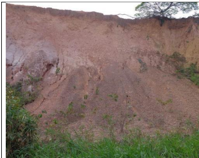
Foto 29 – Ponto 14 - PAM 79 - Talude com processos erosivos (LE). Coordenada UTM: 0634679-9517006. Data – Dezembro de 2015
