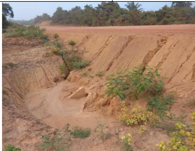
Foto 33 – Ponto 11 - Bueiro Estaca 2401 assoreado (LE). Coordenada UTM 691354-9542191. Data – Dezembro de 2015
