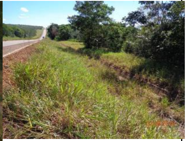
Foto 144 - Passivo recuperado, cobertura do solo implantada e sistema de drenagem superficial (LE). Data: Junho de 2015
