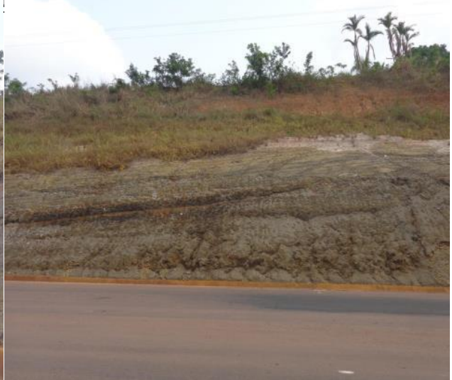
Foto 37 - Ponto 20 - Talude exposto aos agentes erosivos (LD). Coordenada UTM: 680265-9538410. Data - Novembro de 2015
