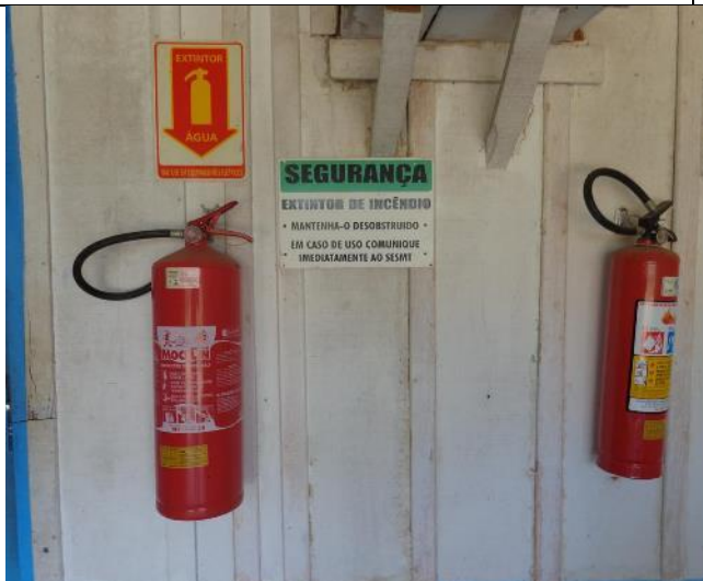
Foto 329 – Extintores dentro do prazo de validade. Data: Maio de 2016
