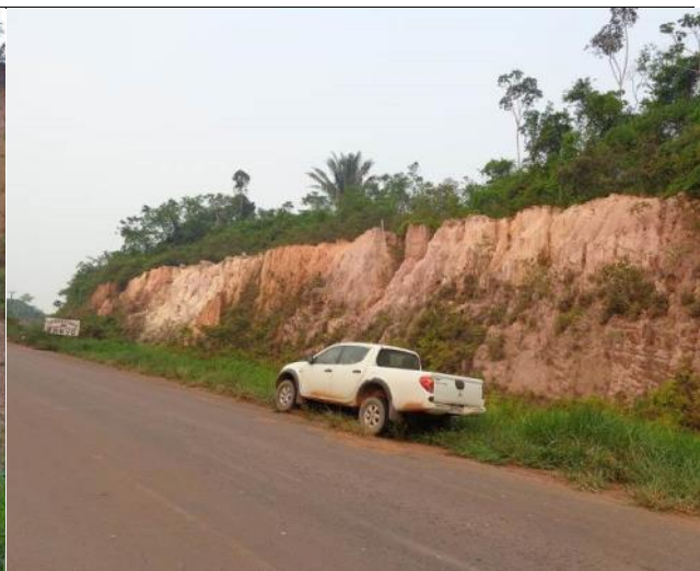
Foto 30 – Ponto 14 - PAM 79 - Talude sem recuperação (LD). Coordenada UTM: 0634679-9517006. Data – Dezembro de 2015
