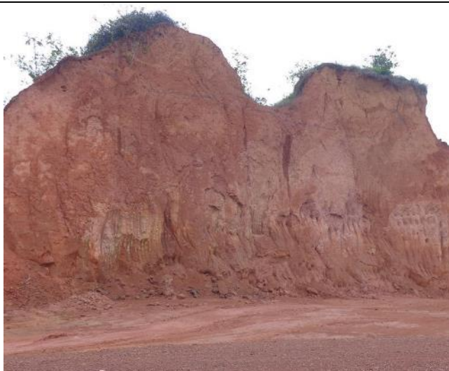
Foto 494 - PAM 75 - Talude sem proteção vegetal. Data: Janeiro de 2016.
