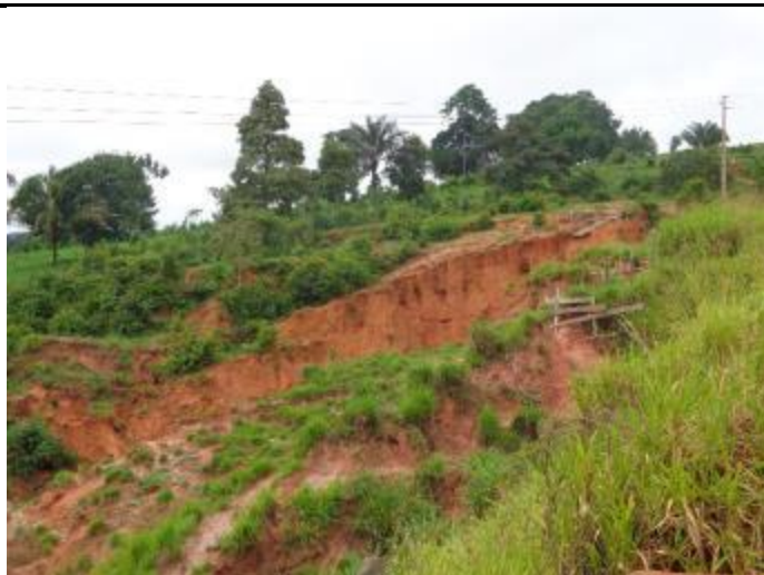
Foto 99 - Erosão na saia de aterro e colapso da drenagem superficial. (LD). Data: Maio de 2016.
