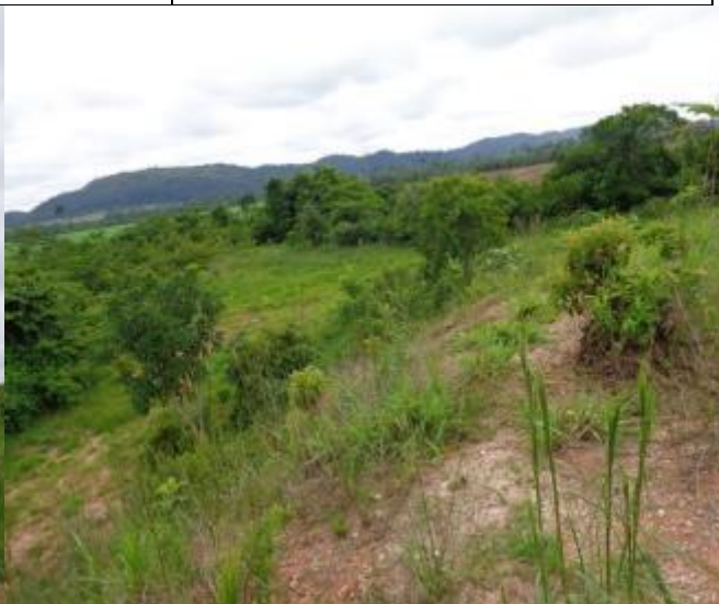
Foto 303 – Talude da jazida com falhas na conformação com gramíneas. LE. Data: Abril de 2016.
