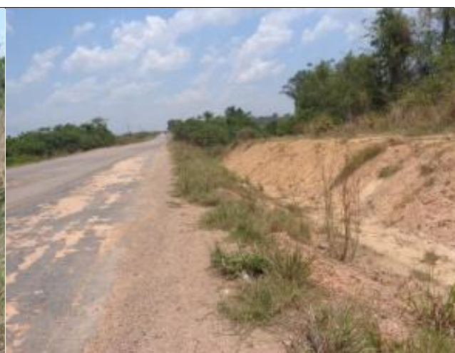
Foto 234 – Ponto 05. Taludes apresentando solo exposto. LE. Data: Fevereiro de 2016
