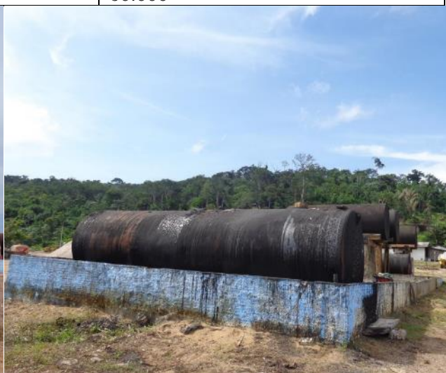
Foto 332 – Bacia de contenção presente em todos os tanques. Tanques desativados. Data: Maio de 2016
