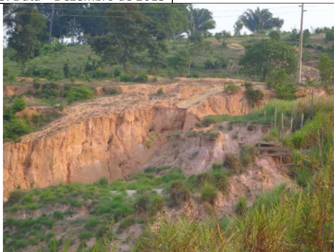
Foto 42 – Ponto 03 - Erosão na saia de aterro e colapso da drenagem superficial. (LD). Coordenada UTM: 0734740-9557566. Data – Dezembro de 2015
