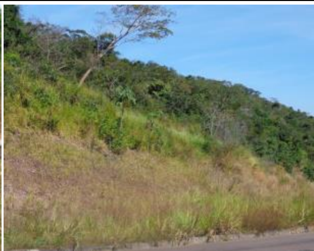
Foto 218-Talude/área de empréstimos com cobertura vegetal (LE). Abril de 2016;
