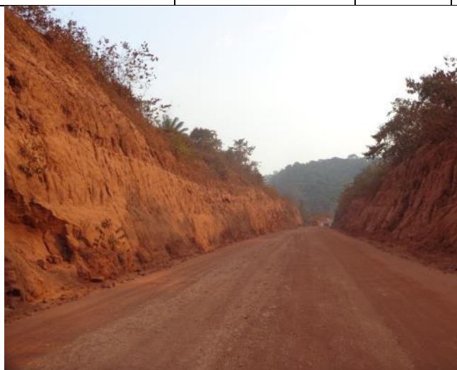
Foto 40 – Ponto 02 - Talude sem proteção ambiental, causando desmoronamento e assim assoreando o corpo hídrico. (LD/LE). Coordenada UTM: 0734612-9558445. Data – Dezembro de 2015
