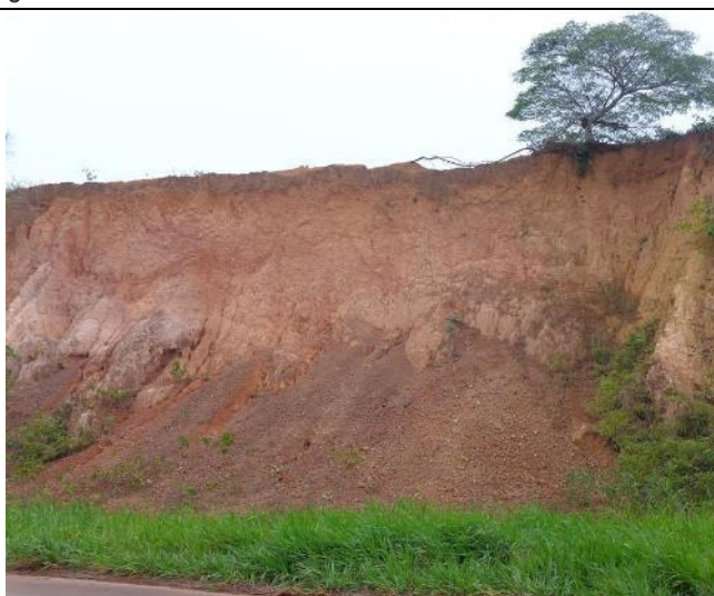
Foto 502 - PAM 79 - Talude com processos erosivos. LE. Data: Janeiro de 2016.
