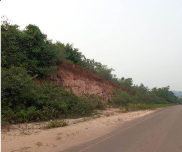
Foto 27 – Ponto 12 - PAM 77 - Talude de corte sem proteção vegetal (LE). Coordenada UTM: 0634360-9514912. Data – Dezembro de 2015
