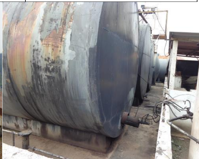
Foto 532 – Tanques de material betuminoso nas baias de contenção. Data: Janeiro de 2016.
