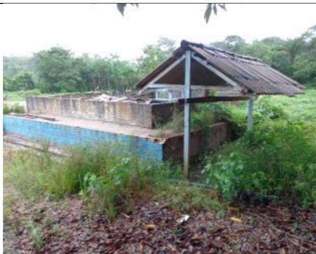
Foto 81 – Posto de abastecimento desativado. Data: Maio de 2016.
