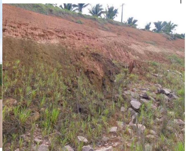
Foto 26 – Ponto 10 - Novo PAM 13. Colapso no sistema de drenagem (LD). Coordenada UTM 0604907/9475958. Data – Dezembro de 2015
