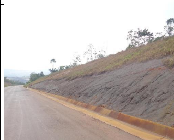
Foto 36 - Ponto 20 - PAM 91 - Talude sem cobertura vegetal (LE). Coordenada UTM: 680265-9538410. Data - Novembro de 2015
