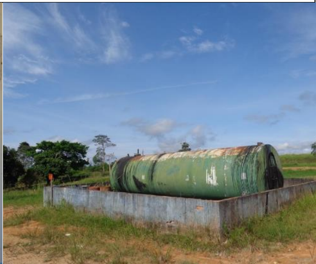
Foto 330 – Bacia de contenção presente nos tanques. Data: Maio de 2016
