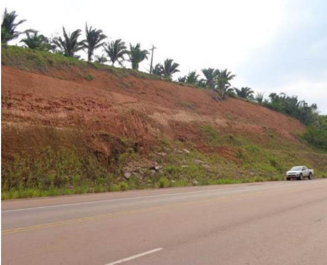
Foto 25 – Ponto 10 - Novo PAM 13 – Talude de corte exposto com processos erosivos (LD). Coordenada UTM 0604907/9475958. Data – Dezembro de 2015
