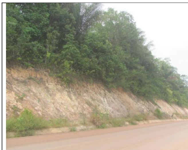
Foto 16 - Ponto 07. Falha na germinação da cobertura vegetal. Face do talude de corte com solo exposto. Coordenada UTM: 642242-9353366. Data - Dezembro de 2015
