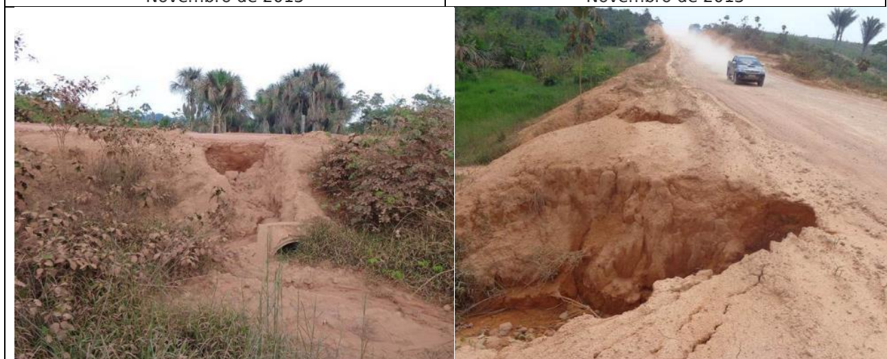
Foto 23 – Ponto 03 - Bueiro obstruído. Talude erodindo (LE). Coordenada UTM 0592425/9440850. Estaca – 15267. Data – Novembro de 2015
