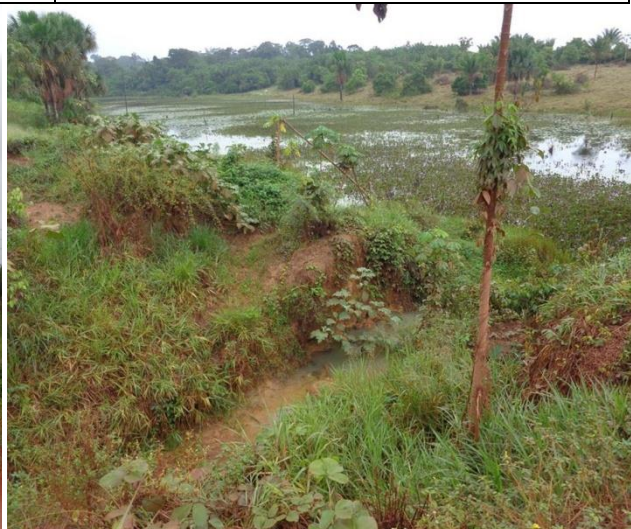
Foto 629 - PAM 101 - Bueiro com processo erosivo. Data: Fevereiro de 2016.
