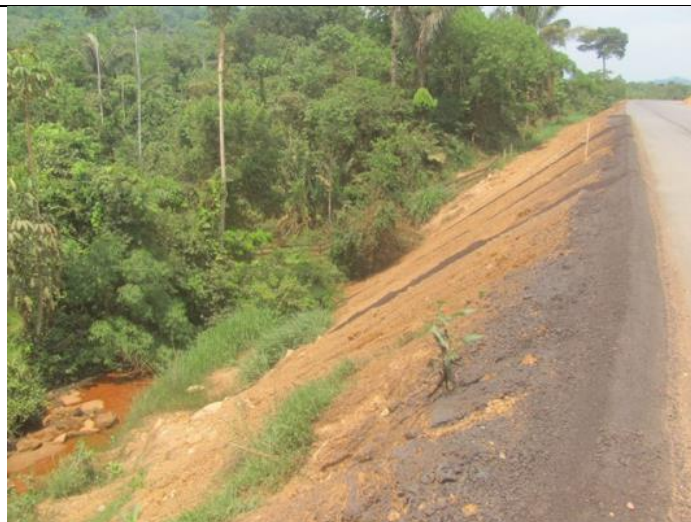
Foto 43 – Ponto 5 - Face do corpo do aterro exposto. Processo erosivo instalado. Vegetação em evolução. Coordenada UTM: 654359-9307733. Data – Novembro de 2015
