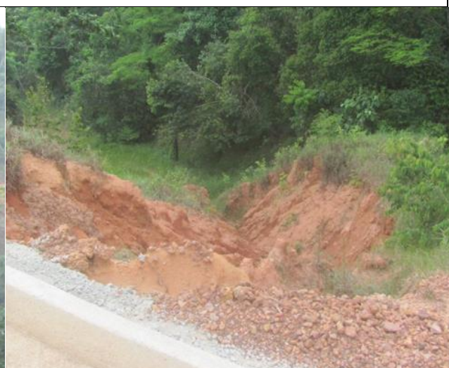
Foto 19 - Ponto 22 - Processo erosivo instalado na face do aterro, estimativa de 100 m 3 de material carreado. Coordenada UTM 624390/9397696. Data - Dezembro de 2015
