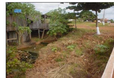
Foto 36 - Saída de esgoto para o rio Tapirapé.
