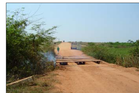
Foto 07 - Córrego Três, detalhe para a ponte em chamas.
