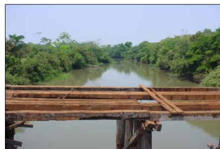
Foto 42 - Rio Xavantinho, detalhe da antiga ponte.
