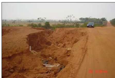
Foto 25 - Voçoroca oferecendo perigo ao tráfego ao longo da estrada.
