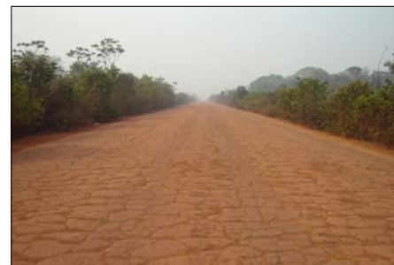
Foto 50 - Detalhe das gretas de contração no leito atual da rodovia.
