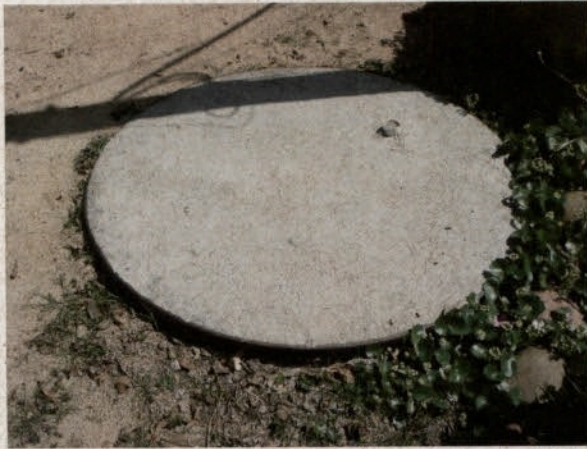
Foto2.5.8 - Poço desativado e lacrado.
