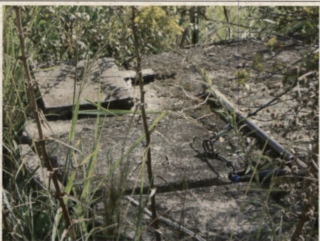
Foto 2.5.2 - Área da bomba do poço.
