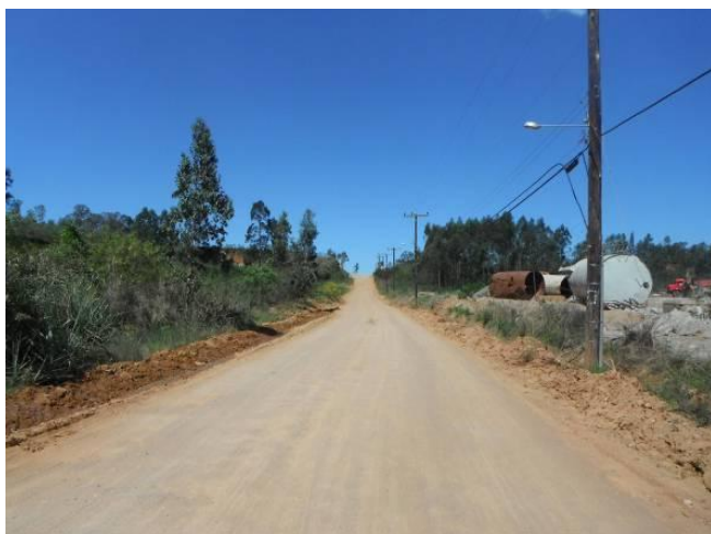
Foto 32. Trecho inicial da Rua Ivon Alcides Dias, limítrofe a empresa de terraplanagem, pavimento de chão batido.
