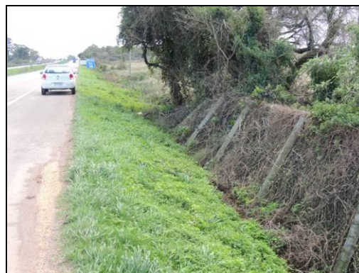
Foto 47. Tela tombada no Banhado do 25 possivelmente pela ação sinérgica do vento, peso das trepadeiras e localização no talude. Agosto de 2015.
