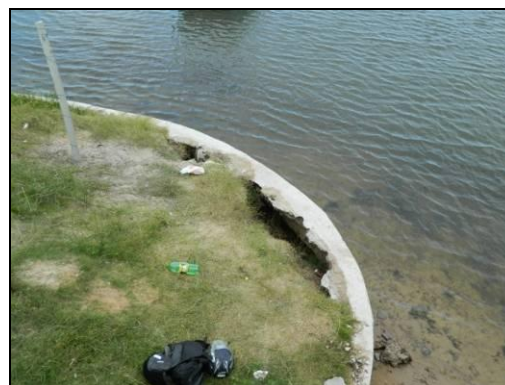
Foto 14. Deterioração do muro de contenção da cabeceira e nível de água elevado impossibilitando a passagem seca para fauna. Janeiro de 2013.
