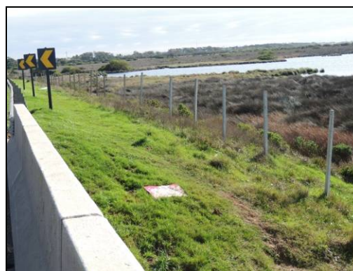
Foto 45. Tela roubada na Ponte do arroio Bolacha (km 14+650). Agosto 2015.
