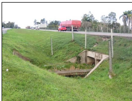
Foto 23. Canteiro central da passagem de fauna do km 36+420 sem tela. Agosto de 2015.
