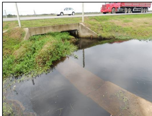
Foto 37. Passagem seca com rachadura que provocou sua submersão. Também se observa a presença de vegetação que esta obstruindo a passagem (51+156). Agosto de 2015.
