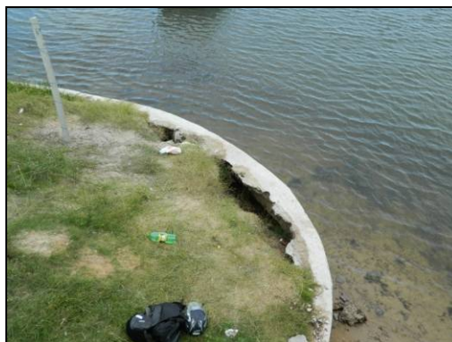
Foto 14. Deterioração do muro de contenção da cabeceira e nível de água elevado impossibilitando a passagem seca para fauna. Janeiro de 2013.
