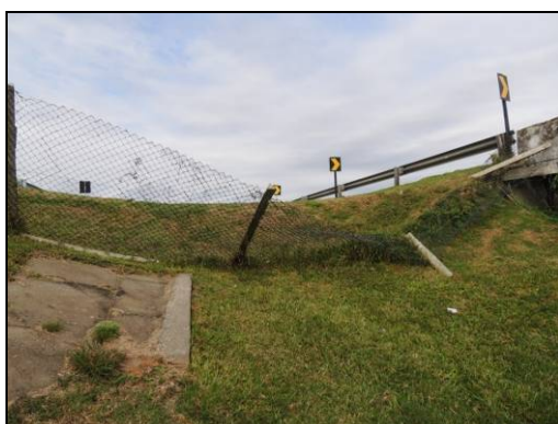
Foto 44. Tela tombada do canteiro central do Viaduto da Várzea III (53+513) devido a rachadura do poste de suporte. Agosto de 2015.
