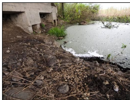
Foto 58. Fezes de capivara na cabeceira da pista velha do Viaduto da Várzea III (km 53+513). Agosto de 2015.
