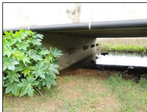
Foto 54. Vão central da cabeceira, na pista antiga, do Viaduto da Várzea II sem passagem seca adaptada. Agosto de 2015.
