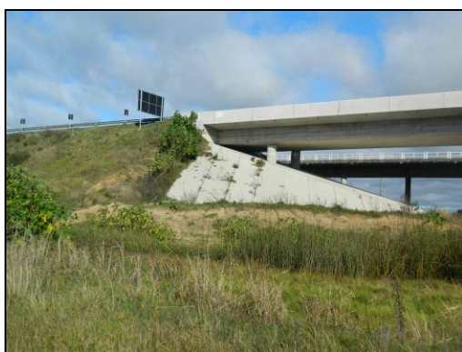
Foto 1. ANTES. Talude do Viaduto. (L3; km 22+700; Abril/2014).
