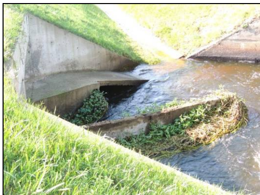
Foto 50. Duto de drenagem do km 23+413 com passagem seca adaptada somente na pista nova. Agosto de 2015.
