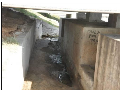
Foto 13. Deterioração da passagem seca pelas alterações do nível de água. Julho de 2013.
