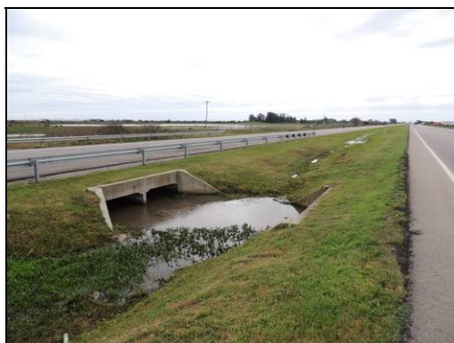
Foto 24. Canteiro central da passagem de fauna do km 49+225 sem tela. Agosto de 2015.
