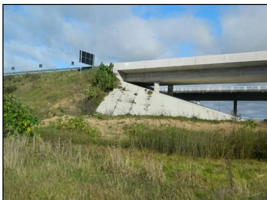
Foto 7. ANTES. Talude do Viaduto. (L3; km 22+700; Abril/2014).
