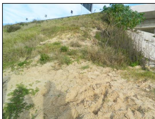
Foto 2. ANTES. Talude do Viaduto. (L3; km 22+700; Abril/2014).
