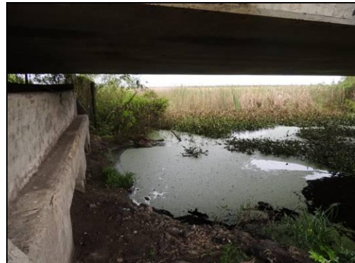
Foto 52. Cabeceira, na Pista Antiga, do Viaduto da Várzea III sem passagem seca adaptada. Agosto de 2015.
