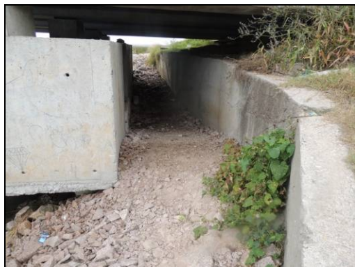
Foto 17. Adequação da passagem com material para manter ela plana e contínua. Agosto de 2014.
