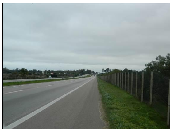
Foto 79. Pista duplicada. Sem dispositivos instalados até o momento (L2; km 35+800; 27/07/2015).
