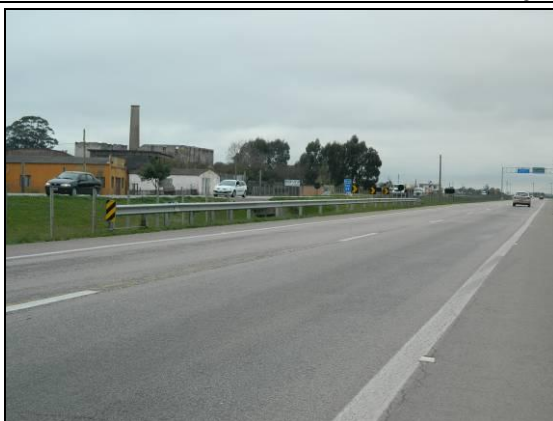
Foto 84. Defensas metálicas no trecho existente e pista duplicada no lado esquerdo da foto sem a instalação dos dispositivos (L3; km 26+000; 27/07/2015).
