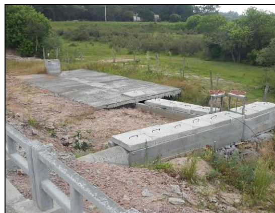
Foto 69. Reservatório de contenção de cargas perigosas – LE (L1, km 522+400; 19/02/2015).
