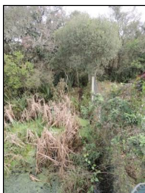
Foto 42. Vegetação de origem aquática obstruindo o acesso da Passagem de fauna do km 51+780 (vista externa). Agosto de 2015.
