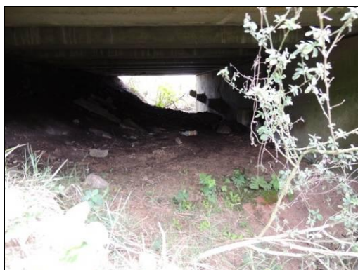
Foto 53. Vão lateral da cabeceira, na pista antiga, do Viaduto da Várzea II sem passagem ótimas para ser utilizado como passagem seca. Agosto de 2015.
