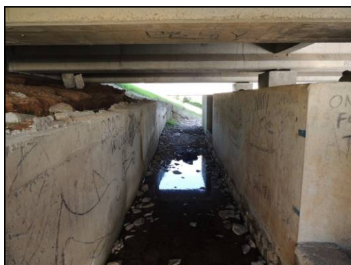
Foto 19. Adequação de passagem seca alterada por falta de manutenção e variações do nível da lâmina de água. Agosto de 2015.
