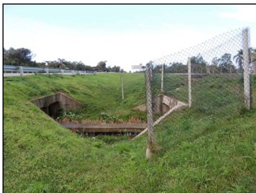
Foto 48. Tela do canteiro central da passagem de fauna do km 35+845 tombada por acidente viário. Agosto de 2015.
