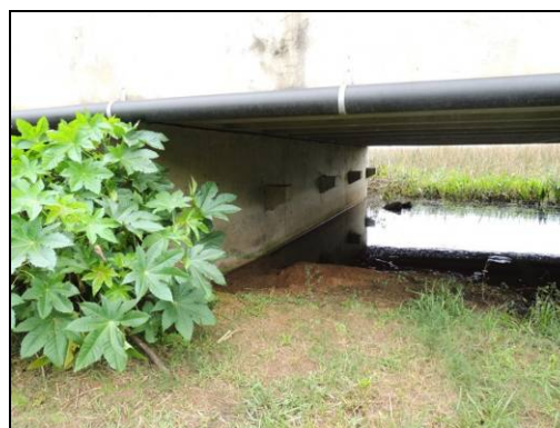
Foto 53. Vão central da cabeceira, na pista antiga, do Viaduto da Várzea II sem passagem seca adaptada. Agosto de 2015.
