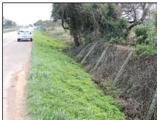
Foto 47. Tela tombada no Banhado do 25 possivelmente pela ação sinérgica do vento, peso das trepadeiras e localização no talude. Agosto de 2015.
