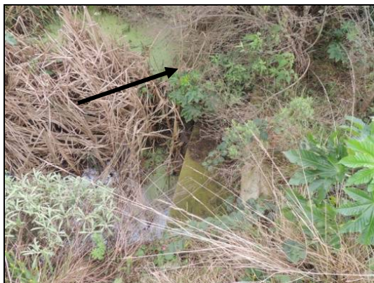
Foto 26. Passagem seca continuada ao terreno natural por meio de uma taipa de solos moles onde a vegetação está se desenvolvendo sem controle ou manutenção.
