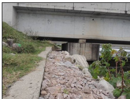
Foto 20. Adequação de passagem seca alterada por falta de manutenção e variações do nível da lâmina de água. Agosto de 2015.
