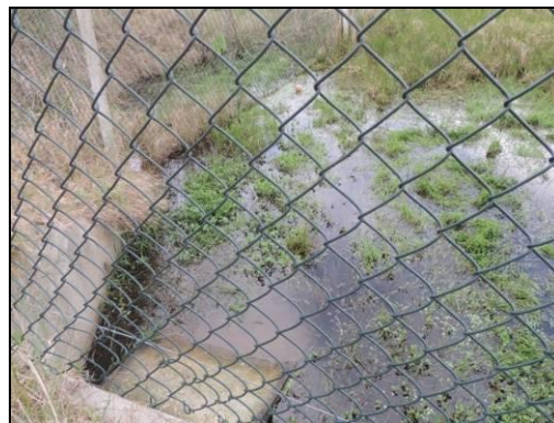
Foto 35. Passagem seca submersa (km 57+500). Agosto de 2015.
