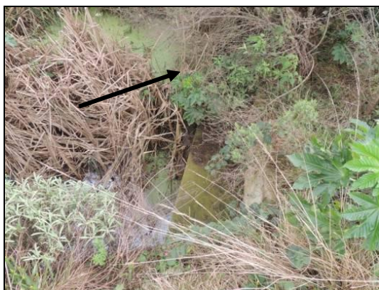
Foto 26. Passagem seca continuada ao terreno natural por meio de uma taipa de solos moles onde a vegetação está se desenvolvendo sem controle ou manutenção.
