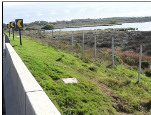
Foto 45. Tela roubada na Ponte do arroio Bolacha (km 14+650). Agosto 2015.
