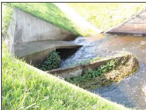
Foto 51. Duto de drenagem do km 23+413 com passagem seca adaptada somente na pista nova. Agosto de 2015.
