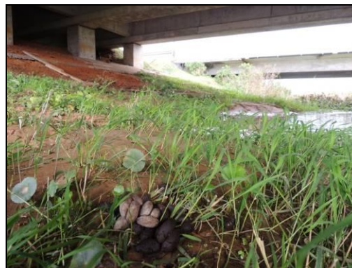
Foto 56. Fezes de capivara na passagem seca da pista nova do Viaduto da Várzea III (km 53+513). Agosto de 2015.
