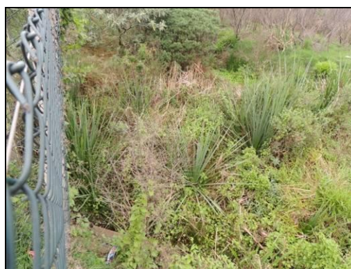
Foto 43. Vegetação obstruindo o acesso da Passagem de fauna do km 35+845 (vista externa). Agosto de 2015.
