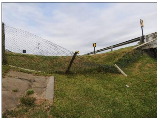
Foto 44. Tela tombada do canteiro central do Viaduto da Várzea III (53+513) devido a rachadura do poste de suporte. Agosto de 2015.
