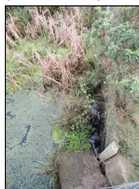
Foto 39. Taipa de solos moles para dar continuação da passagem seca ao terreno natural vegetada parcialmente (km 51+780). Agosto de 2015.
