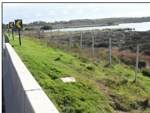
Foto 22. Ponte Bolacha sem telamento por roubo. Agosto de 2015.
