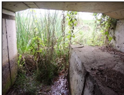
Foto 41. Vegetação obstruindo o acesso da Passagem de fauna do km 36+420 (vista interna). Agosto de 2015.
