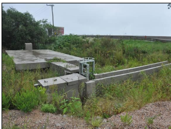
Foto 68. Reservatório de contenção de cargas perigosas – LD (L1, km 523+290; 19/03/2014).
