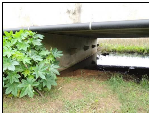
Foto 54. Vão central da cabeceira, na pista antiga, do Viaduto da Várzea II sem passagem seca adaptada. Agosto de 2015.
