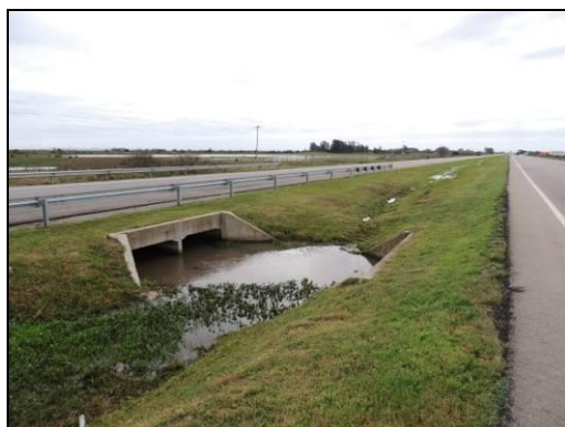
Foto 24. Canteiro central da passagem de fauna do km 49+225 sem tela. Agosto de 2015.
