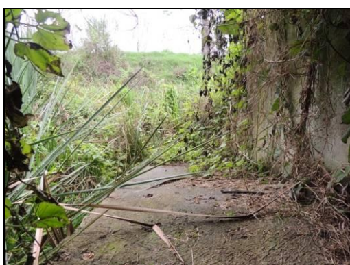
Foto 38. Vegetação obstruindo a passagem seca da passagem de fauna do km 36+420. Agosto de 2015.
