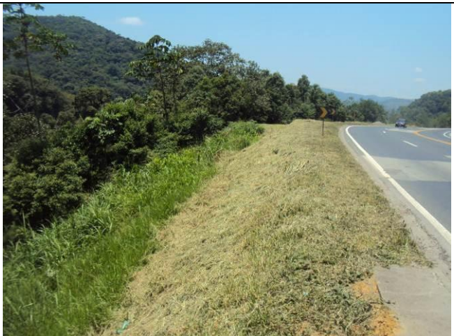
Foto 4 – Plataforma de aterro à direita da pista sentido São Paulo da BR-116. Estaca 18020.
