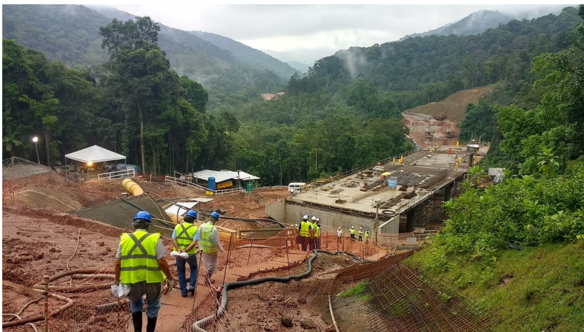
Imagem 09. Áreas de apoio e de instalação do desemboque sul do Túnel 04 e OAes 08 e 09.
