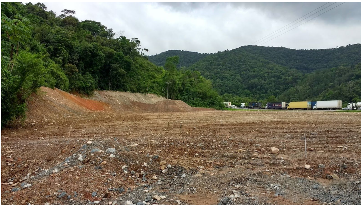
Imagem 35. DME Km 361+700. Esta área se encontra em pleito para retomada das atividades de deposição de material.
