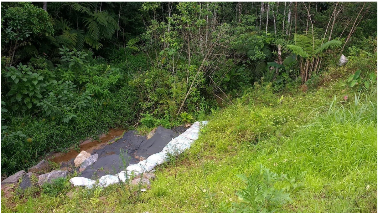
Imagem 30. DME Km 355+250/S. Dispositivos de contenção do carreamento de material sólido. Nota-se o assoreamento de curso hídrico posicionado além da contenção, evidenciando a ineficiência dos dispositivos de mitigação de impactos ambientais.
