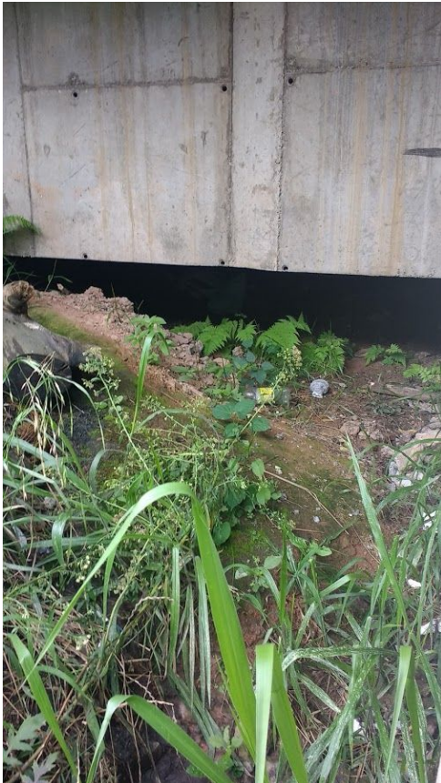
Imagem 05. Vão obstruído sob a OAE 6 (km 348).
