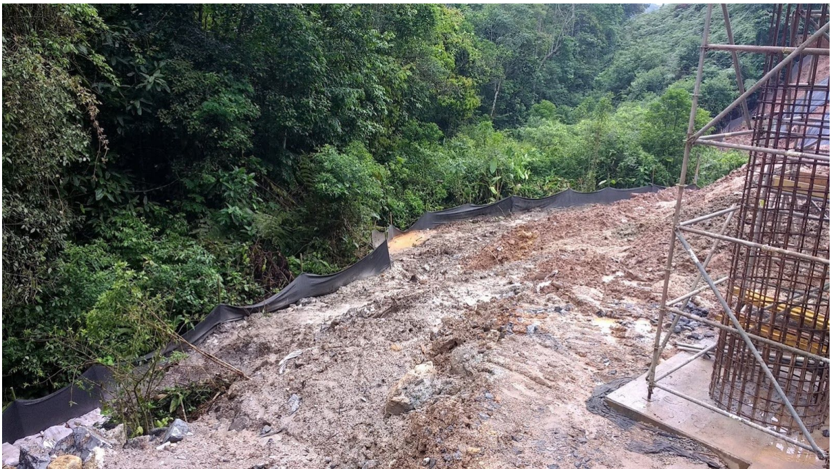
Imagem 18. Dispositivo de contenção de carreamento de sedimento às margens do Acesso às obras do desemboque sul do Túnel 04 e das OAEs 08 e 09.
