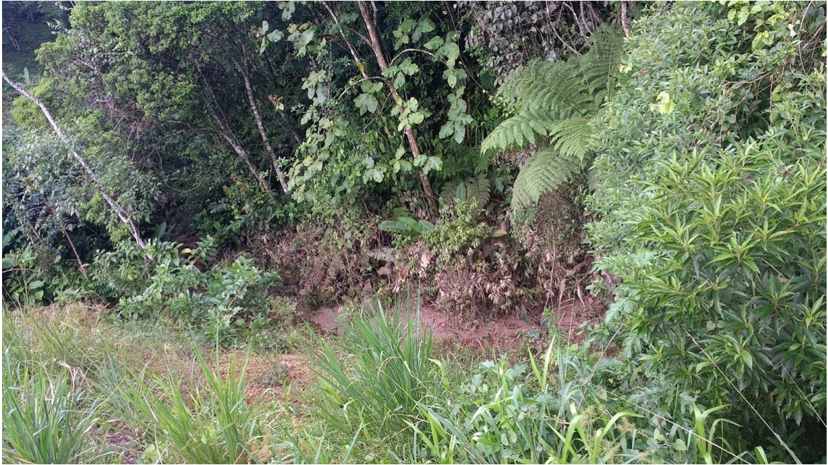
Imagem 31. DME Km 355+250/S. Curso hídrico em avançado processo de assoreamento. Nota-se a inexistência de medidas mitigadoras neste ponto.
