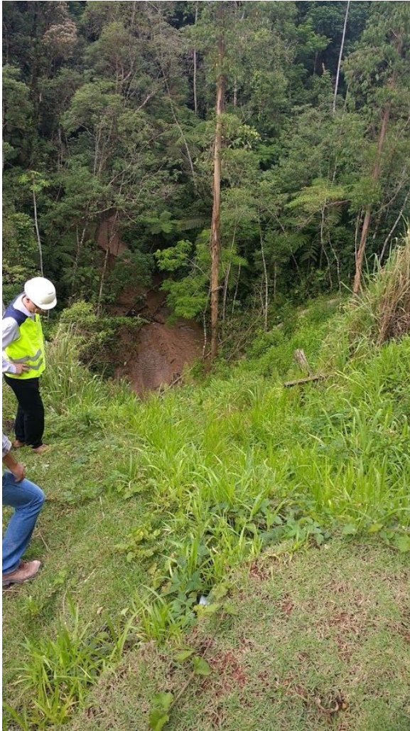
Imagem 03. Curso hídrico às margens das OAEs 06 e 07 da rodovia (km 348). Nota-se o intenso processo de assoreamento do curso hídrico.
