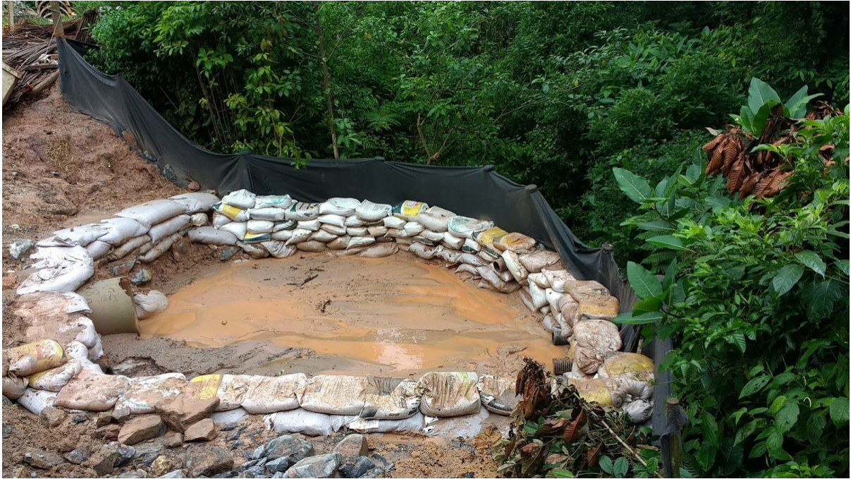
Imagem 17. Dispositivo de drenagem e contenção para carreamento de sedimento às margens do Acesso às obras do desemboque sul do Túnel 04 e das OAEs 08 e 09.
