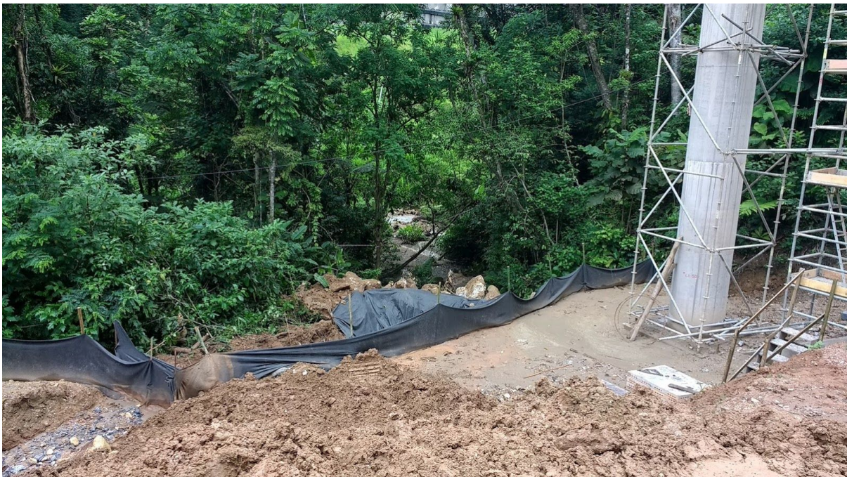
Imagem 24. OAE 13. Estrutura para contenção de sedimentos ineficiente. Nota-se, ao fundo, corpo hídrico em processo de assoreamento.
