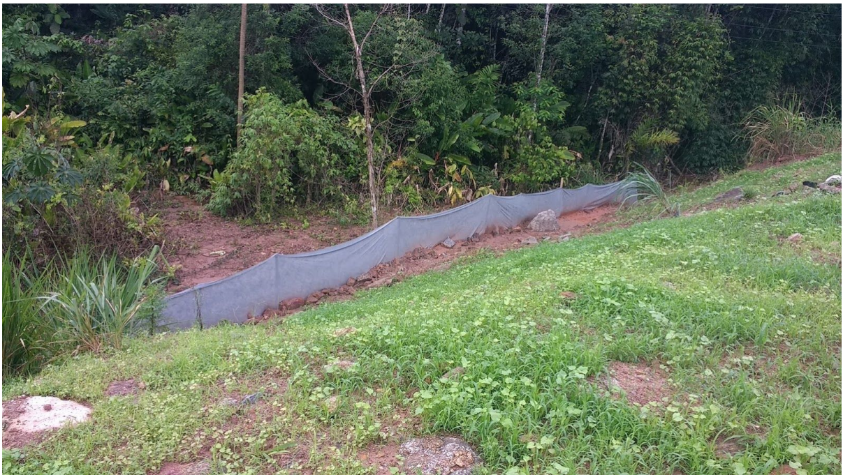
Imagem 32. DME Km 355+250/S. Dispositivos de contenção do carreamento de material sólido. Nota-se o carreamento de material sólido do aterro ao ponto localizado além da contenção.
