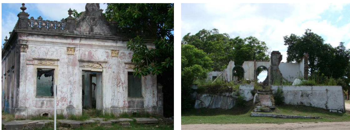
Figura 5.3-120 Casario antigo, em ruínas. São Lourenço do Sul
