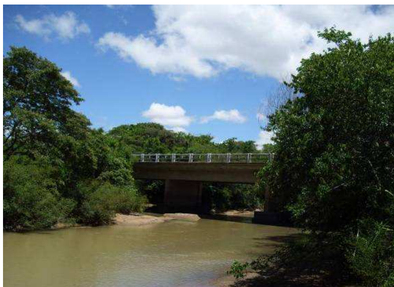
Foto 5.2-32 Arroio Ribeiro na área de influência direta da duplicação da rodovia BR 116 (trecho Guaíba – Pelotas).
