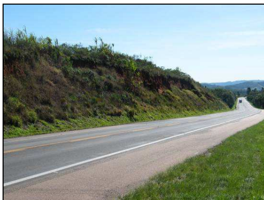
Foto 5.1-39 Situação inicial de desmoronamento de talude artificial em situação de argissolo e relevo movimentado.
