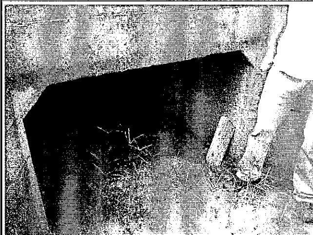
Foto 39: visão da passagem de fauna largamente assoreada.
