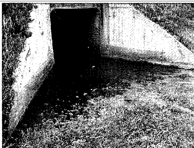
Foto 64: passagem de fauna com água acumulada em seu interior.
