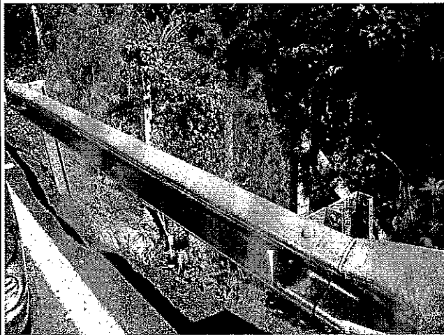
Foto 36: defesa metálica implantada sobre o emboque da passagem de fauna, garantindo maior segurança aos usuários da rodovia.
