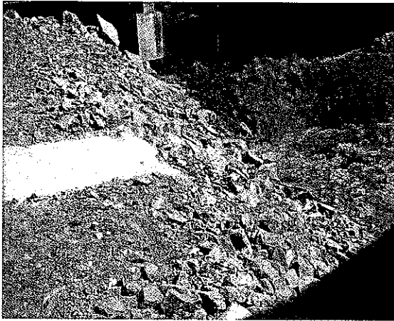
Foto 09: Rochas para conter o processo erosivo e canaleta de drenagem direcionando a água pluvial - rio Sangão - km 358,65
