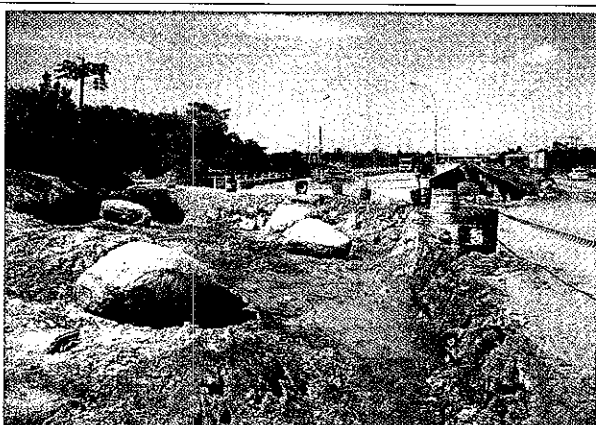
Foto 4: Construção da nova ponte sobre o rio Massiambu quase concluída, quando será liberada para tráfego e fechada a antiga ponte para reformas estruturais.
