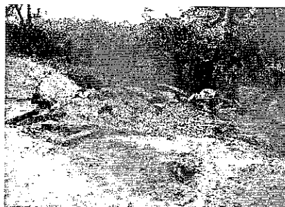
Foto 13 - entulho proveniente da obra.
