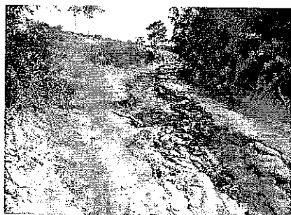
Foto 12 - erosão na estrada de acesso à propriedade - km296 lado direito.
