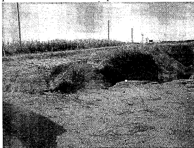
Foto 5 – Processo erosivo instalado próximo à via de acesso à jazida J3, lote 29/SC.
