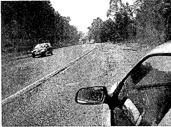
Foto 03 – Lote 22/SC – Alargamento no Morro dos Cavalos.
