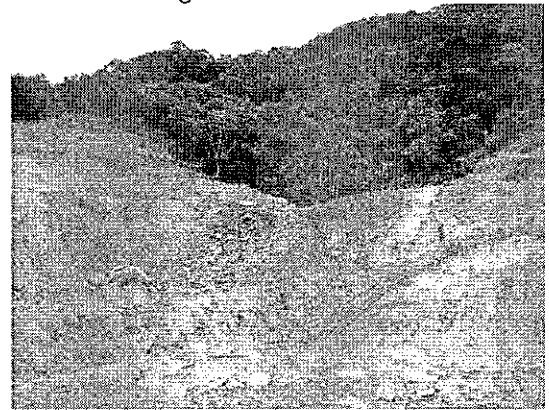
Foto 28 – Lote 23/SC – Emboque sul do Morro Agudo. Queda d'água e taludes instáveis.
