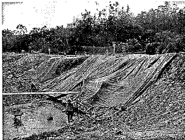
Foto 18: Talude revestido com lona plástica para evitar novos desmoronamentos em virtude das chuvas
