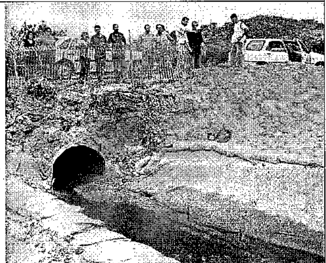
Foto 12 - Processo erosivo na área de entorno do sistema de drenagem, Lote 04/RS.
