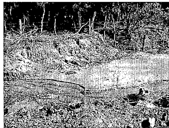
FIGURA 24 – Assoreamento em local de rompimento bueiro – Lote 01.
