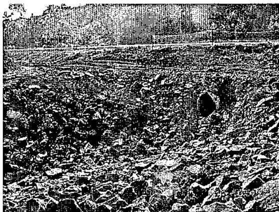
FIGURA 23 – Enrocamento em bueiro rompido – Lote 01.
