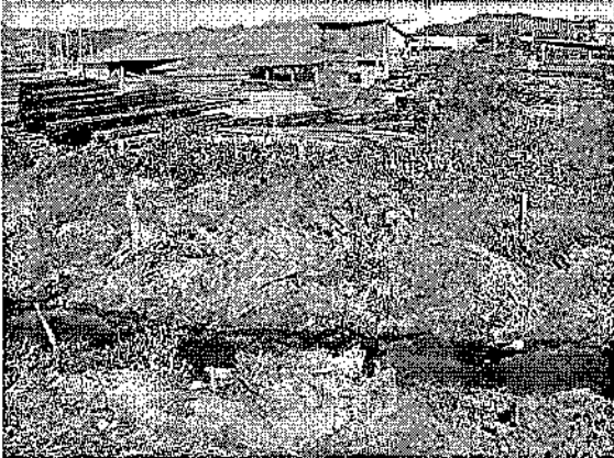
FIGURA 01 – Material de supressão de vegetação e acúmulo de água no Lote 22.
