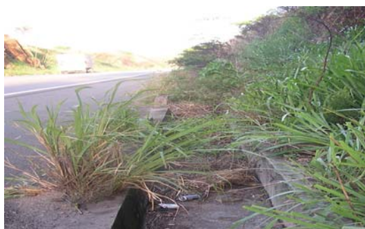
Foto B – acostamento e canaleta de drenagem invadidos pela vegetação.
