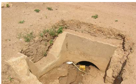
Foto E – bueiro entupido.
