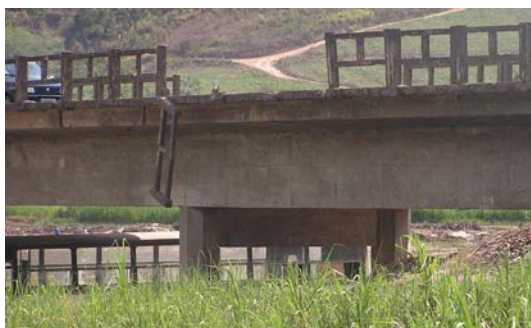
Foto C – guarda corpo da ponte danificado.
