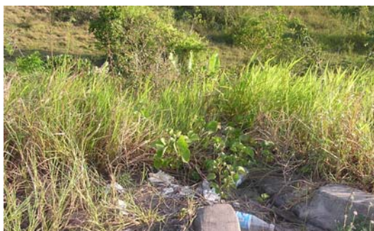
Foto D – descida de água invadida por lixo e vegetação.
