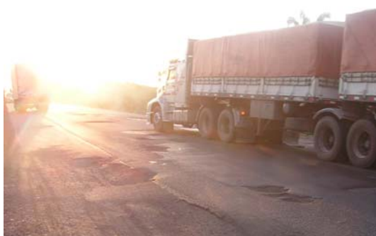
Foto A – buracos na pista de rolamento.
