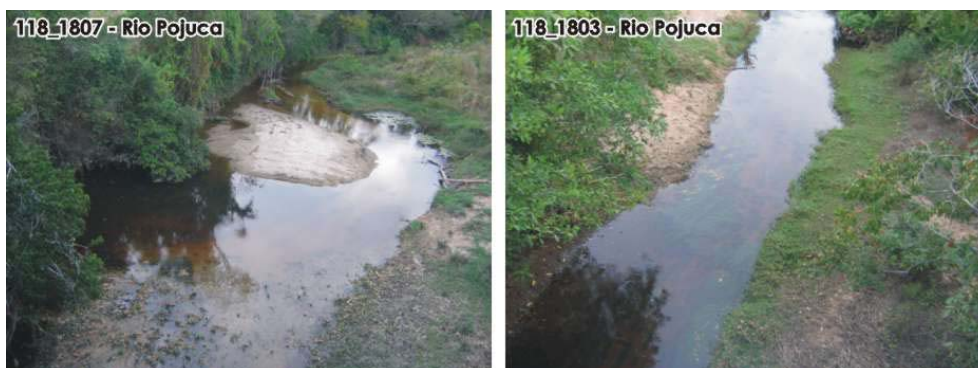
Foto 118_1807: Montante (lado direito da rodovia) vista sobre a ponte. Foto 118_1803: Jusante (lado esquerdo da rodovia) vista sobre a ponte.
