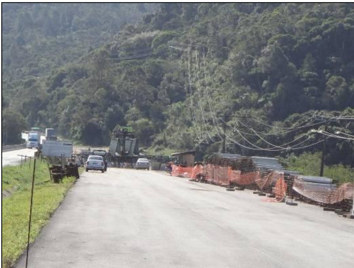
Figura 11. Aspecto geral da área do desmatamento – setor sul.
