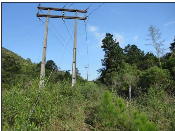
Rede de Distribuição Elétrica de Média Tensão
