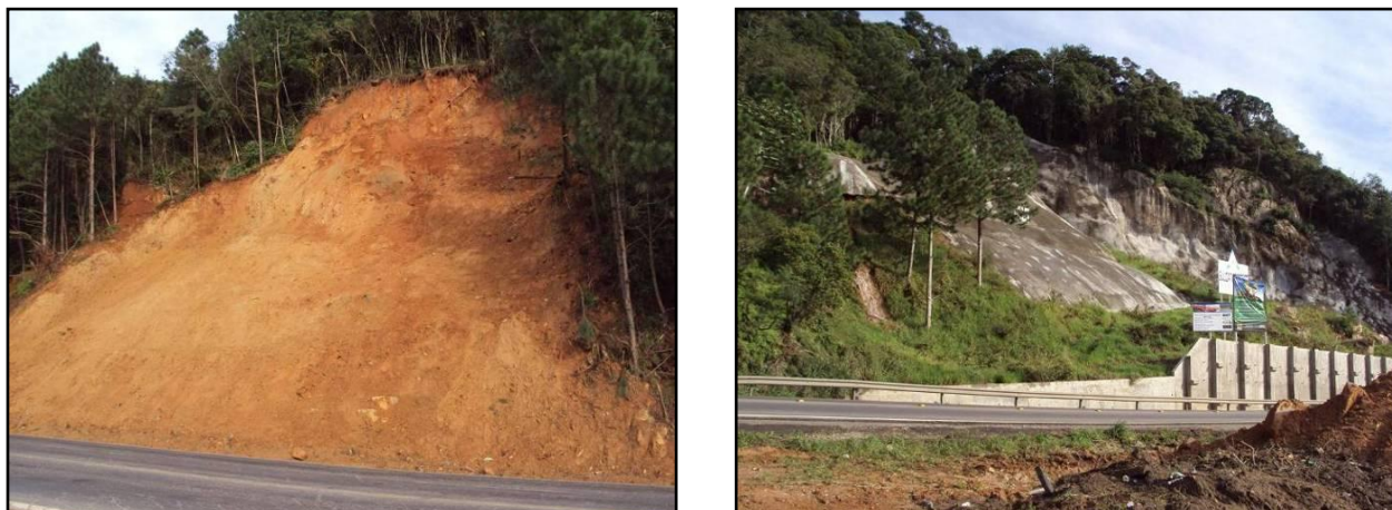
Figura 21. As imagens fotográficas mostram locais de escorregamentos recentes acontecido nos taludes de montante da margem direita da BR-101.
