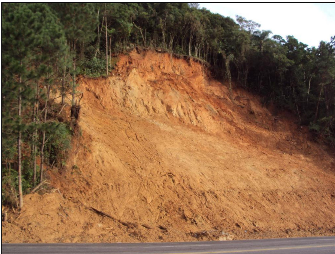
Figura 45. A imagem fotográfica mostra o escorregamento ocorrido no talude de corte da BR-101 atual.
