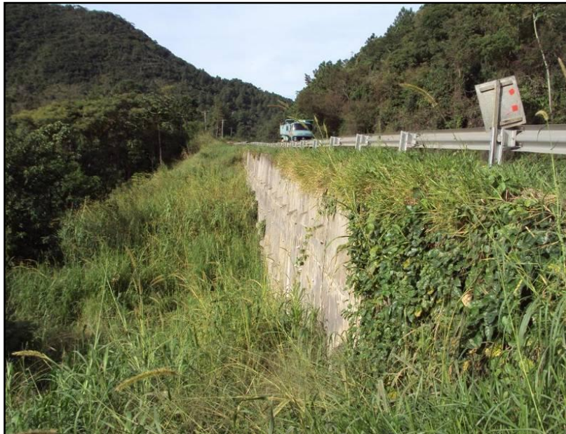
Figura 24. A imagem fotográfica mostra uma cortina atirantada utilizada para conter o talude esquerdo da BR-101 atual.
