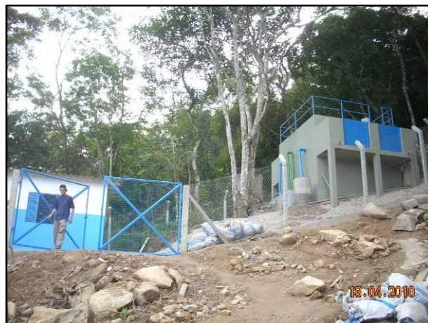
Estação Tratamento de Água – Morro dos Cavalos
