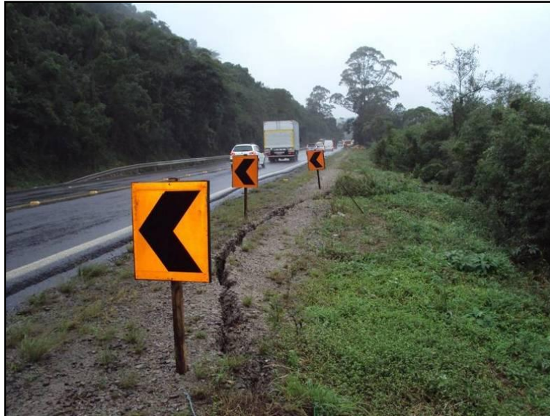
Figura 25. A imagem fotográfica mostra uma superfície de ruptura de 10,0m a 15,0m de extensão, com rejeito vertical de 2,0cm a 5,0cm e rejeito horizontal de 5,0cm a 10,0cm, instalada no acostamento no talude do lado direito da BR-101 atual, que corrobora que as encostas neste local são sujeitas a deslizamento e instabilização.
