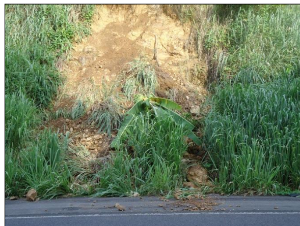
Figura 6.3.72 - Taludes Localizados Próximos a Rodovia, em Aurelino Leal e Itacaré.
