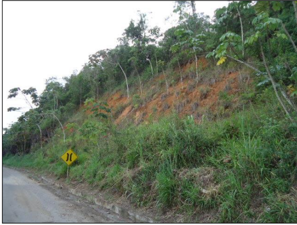
Figura 6.3.64 - Talude Localizado Próximo a Rodovia, em Gandu e Movimentação de Solo, em Ibirapitanga.
