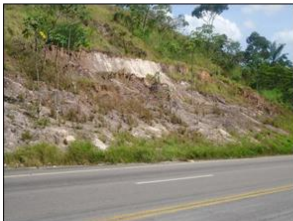
Figura 6.3.37 - Características De Processos de Erosão e Instabilidade de Taludes, em Governador Mangabeira E Muritiba.
