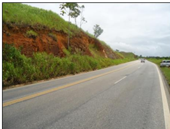
Figura 6.3.93 - Processos Erosivos Ao Longo Da Rodovia, Em Belmonte E Itapebi
