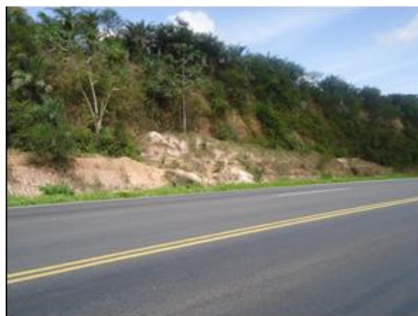
Figura 6.3.38 - Características de Processos De Erosão e Instabilidade de Taludes, em Governador Mangabeira E Muritiba.
