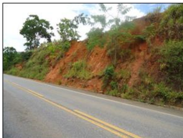
Figura 6.3.92 - Processos Erosivos ao Longo da Rodovia, em Belmonte e Itapebi.
