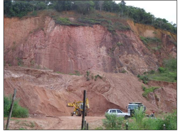
Figura 6.3.65 - Talude Localizado Próximo a Rodovia, em Gandu e Movimentação de Solo, em Ibirapitanga.
