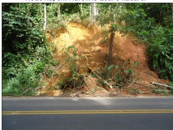
Figura 6.3.73 - Taludes Localizados Próximos a Rodovia, em Uruçuca e Itabuna.
