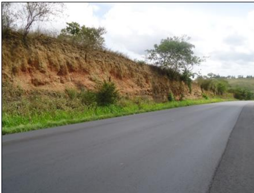
Figura 6.3.39 - Características de Processos de Erosão e Instabilidade de Taludes, em Governador Mangabeira E Muritiba.
