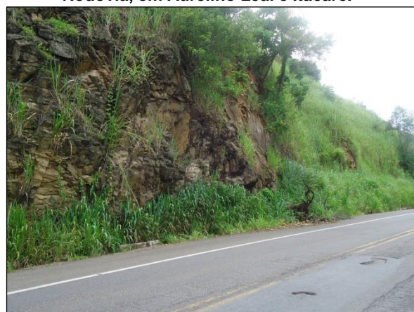
Figura 6.3.74 - Taludes Localizados Próximos a Rodovia, em Uruçuca e Itabuna.
