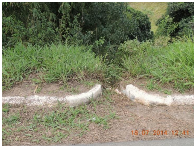
Foto 23 - Lado esquerdo: drenagem de águas pluviais.
