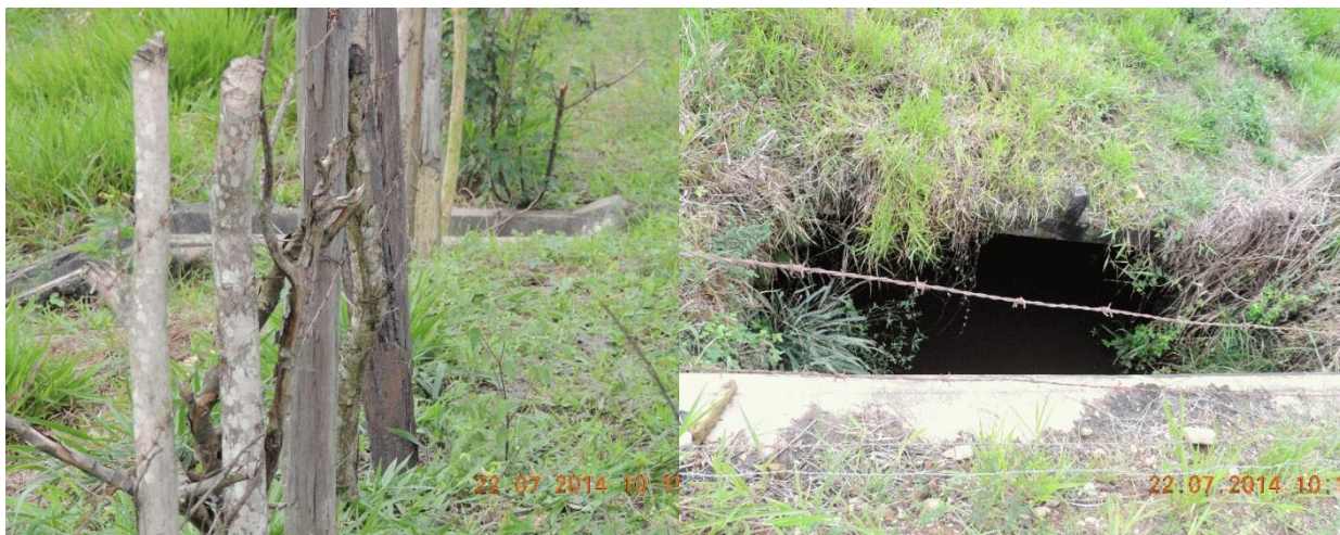
Foto 142 – Lado esquerdo: drenagem
