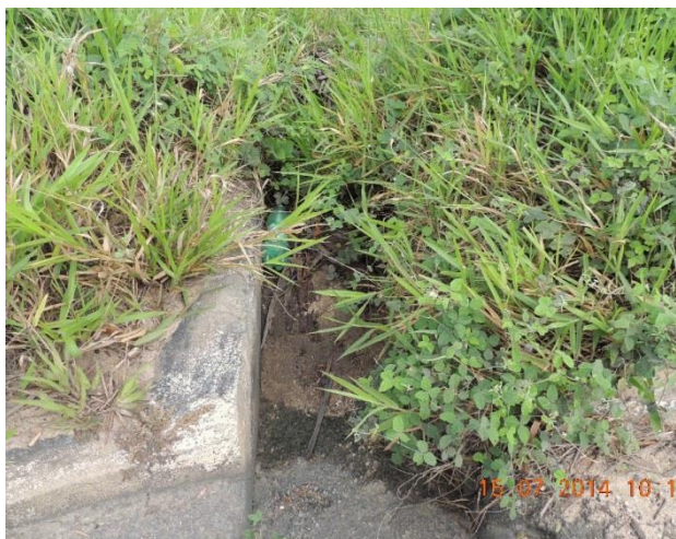
Foto 153 – Lado esquerdo: drenagem
