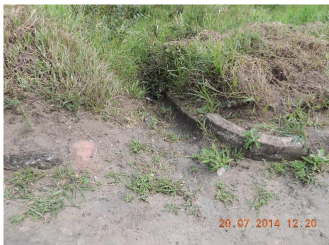
Foto 47 – Lado direito: drenagem de águas pluviais.
