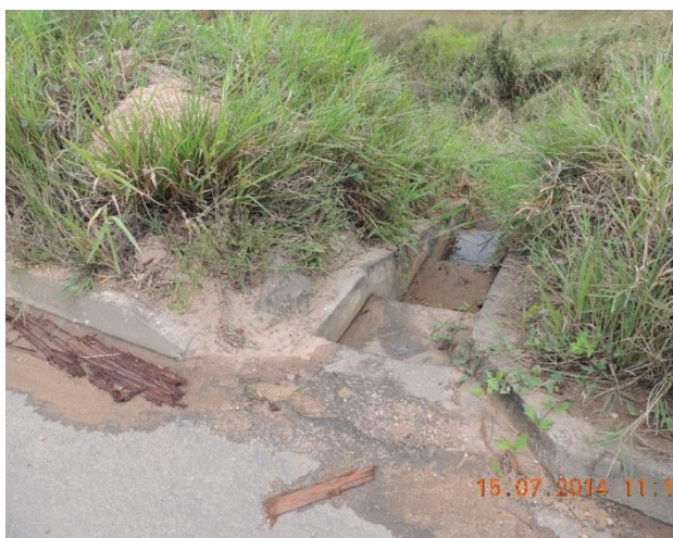
Foto 146 – Lado esquerdo: drenagem
