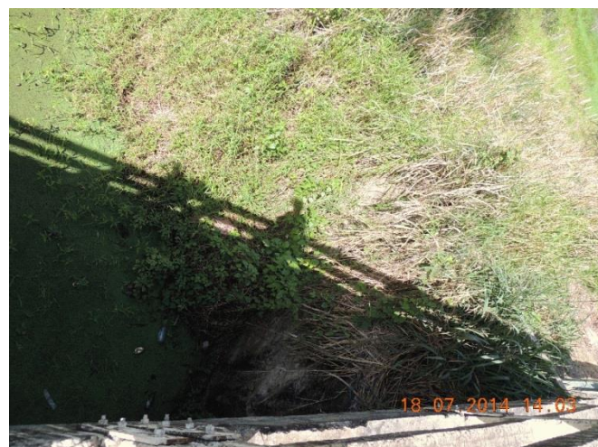
Foto 18 - Lado esquerdo: estrutura de apoio da ponte e presença de lixo no rio Jequitibá.
