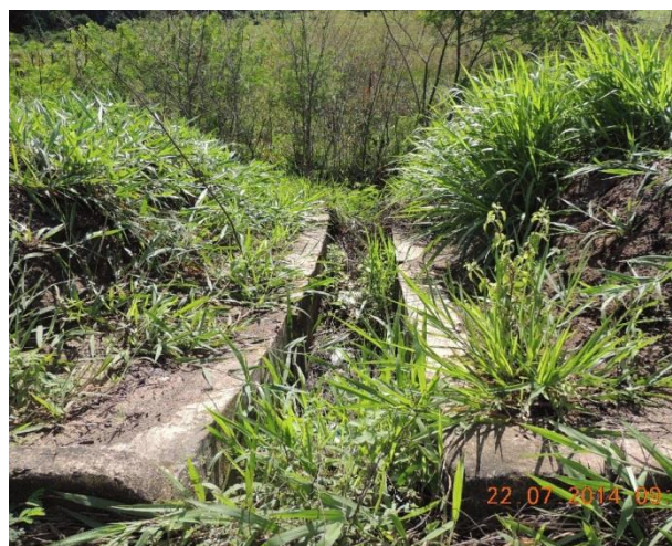
Foto 158: Lado esquerdo: drenagem pluvial.
