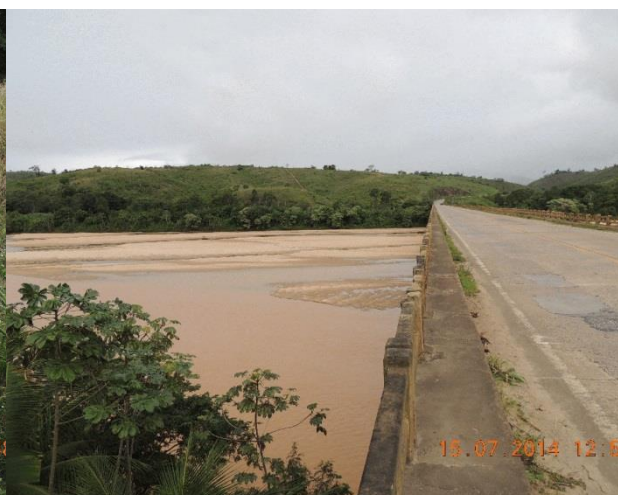
Foto 135 – Lado esquerdo: assoreamento no leito do rio
