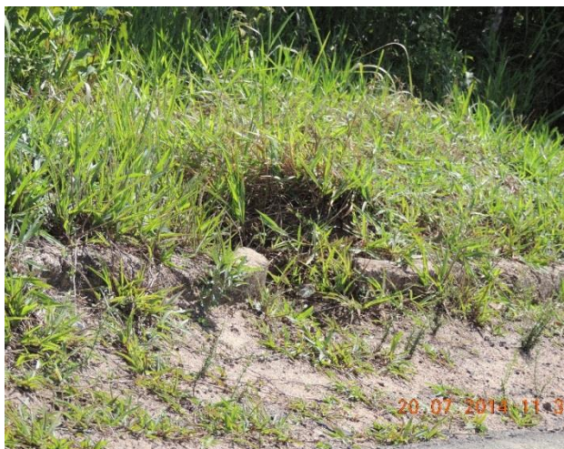
Foto 41 - Lado direito: Drenagem de águas pluviais.
