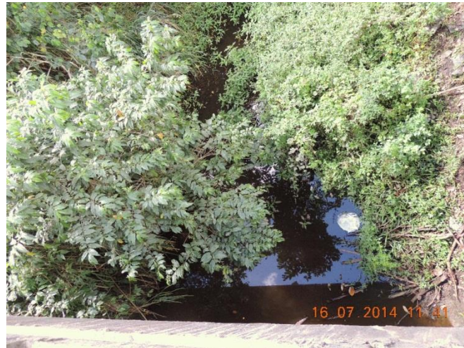
Foto 85 – Lado esquerdo: assoreamento no leito do rio
