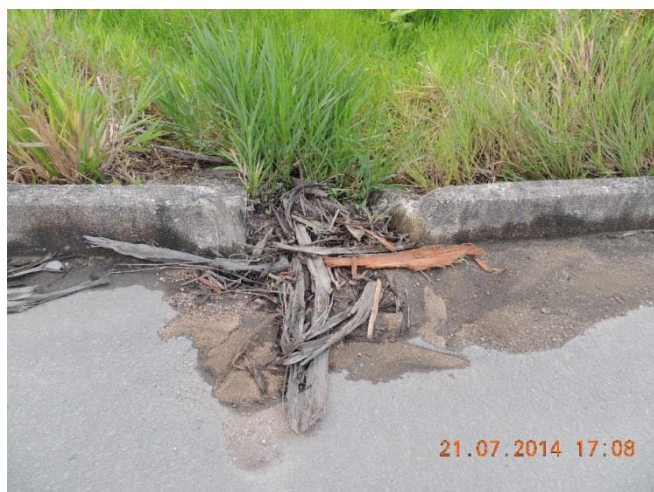
Foto 139 – Lado esquerdo: drenagem de águas pluviais
