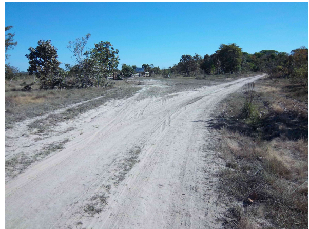
FIGURA 68 - Aspecto observado em via de acesso para fazenda. Situação característica observada em outras propriedades da região.
