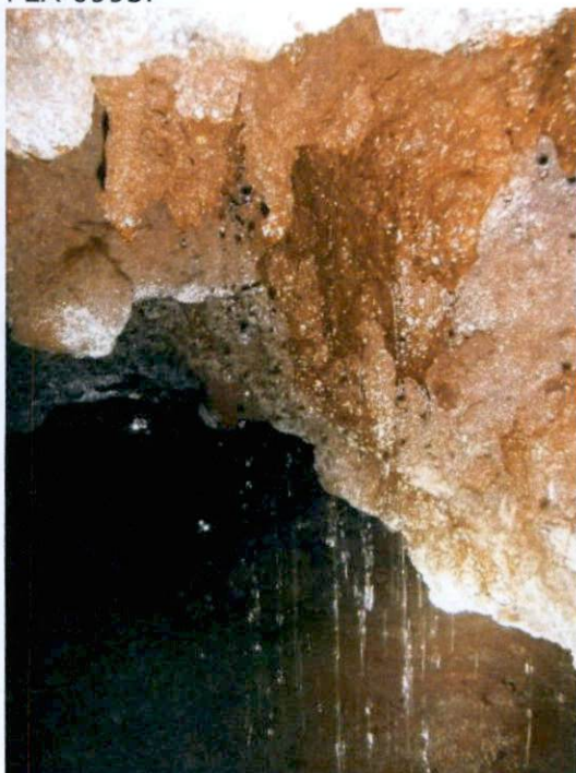
Figura 55 - Gotejamento intenso no interior da PEA-0993.
