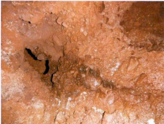
Figura 74 - Ponto de infiltração/gotejamento no interior da PEA-585.
