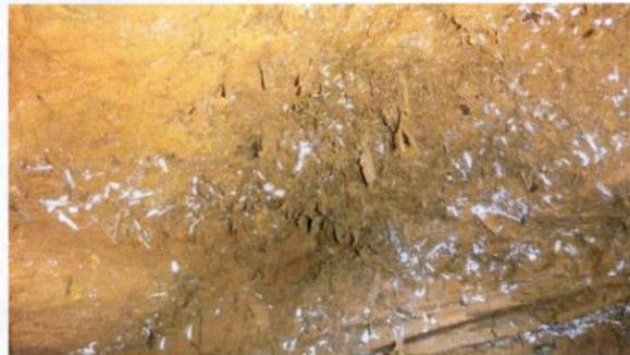
Figura 150 – Raízes finas no teto da cavidade encontradas na cavidade PEA-0576 durante a estação chuvosa, em fevereiro de 2019.
