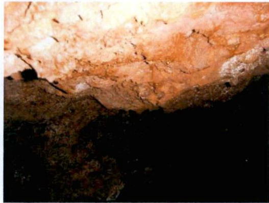
Figura 49 - Ponto de gotejamento no interior da PEA-0579.
