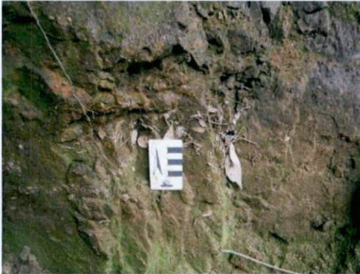
Figura 83 - Acúmulos de galhos e folhas carreados por eventos atmosféricos na entrada da PEA-0587.
