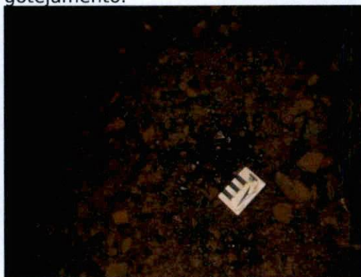
Figura 67 - Piso da PEA-583 sob ponto de gotejamento.
