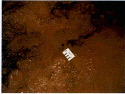
Figura 61 - Piso da PEA-995 sobre o gotejamento intenso em canalículo.
