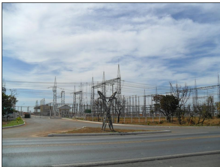
Foto 11 - Central de Distribuição de Energia da Linha de Transmissão Serra da Mesa, Luziânia/GO (Coordenadas: 196970 / 8191332).
