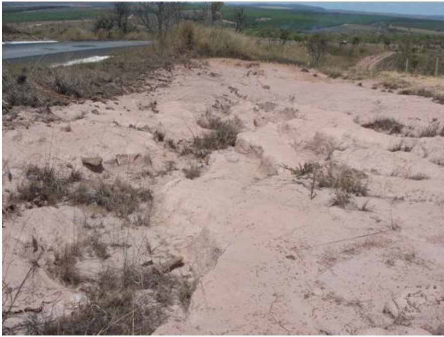
Foto - 96 - Processo erosivo característico das áreas da Província Tocantins.
