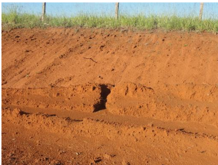
Foto - 30 – Início do processo de erosão linear em talude.
