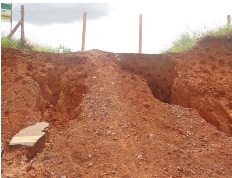
Foto - 112 – Sem proteção os taludes são facilmente erodidos devido à declividade.
