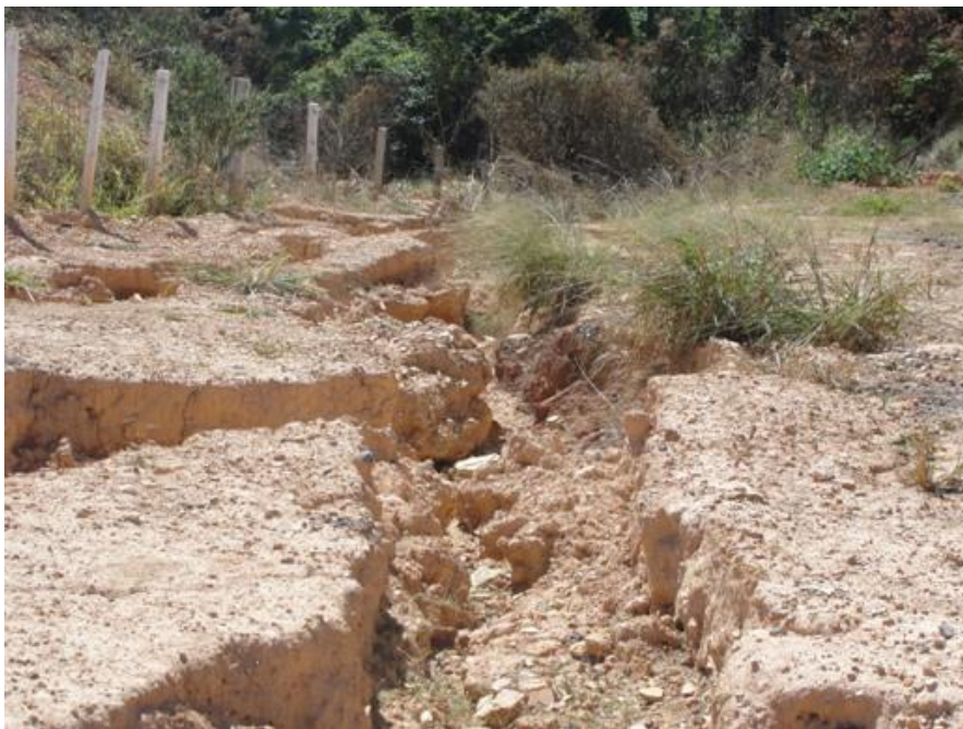
Foto - 97 - Processo erosivo característico das áreas da Província Tocantins.
