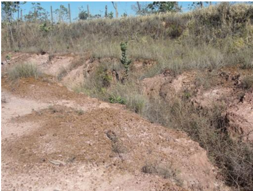
Foto - 95 - Processo erosivo característico das áreas da Província Tocantins.
