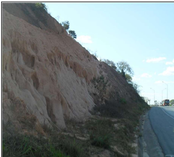
Foto 3 - Talude na Faixa de Domínio com Erosão em Sulcos e Escorregamentos devido à Inclinação Acentuada e sem Vegetação, com Desmoronamento. Solo arenoso - km 511,8 - Ribeirão das Neves/MG
