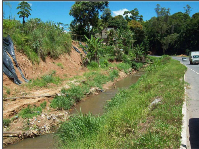
Foto 7 - Desmoronamento de APP de Curso D'água. Contenção com lonas plásticas - km 748,6 - Santos Dumont/MG.
