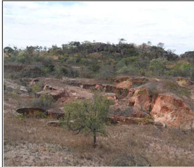
Foto 4 - Área de Empréstimo com Água Acumulada. Erosão e Voçorocas Extensas. Km 100,4 - Cristalina/GO.
