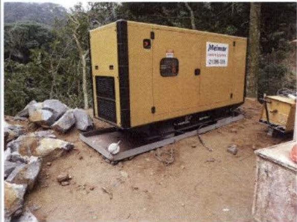
Foto 36: BR 040 – Frente de obra km 87. Gerador elétrico.
