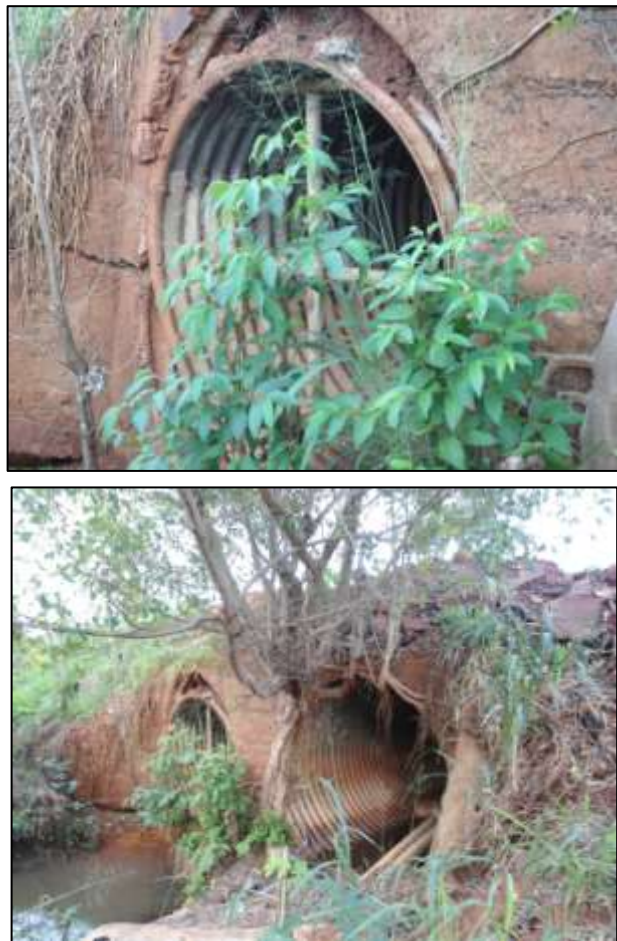
Figura 4 - Galerias da AHS identificada no km 859+600 na BR-365/MG em mal estado de conservação.
