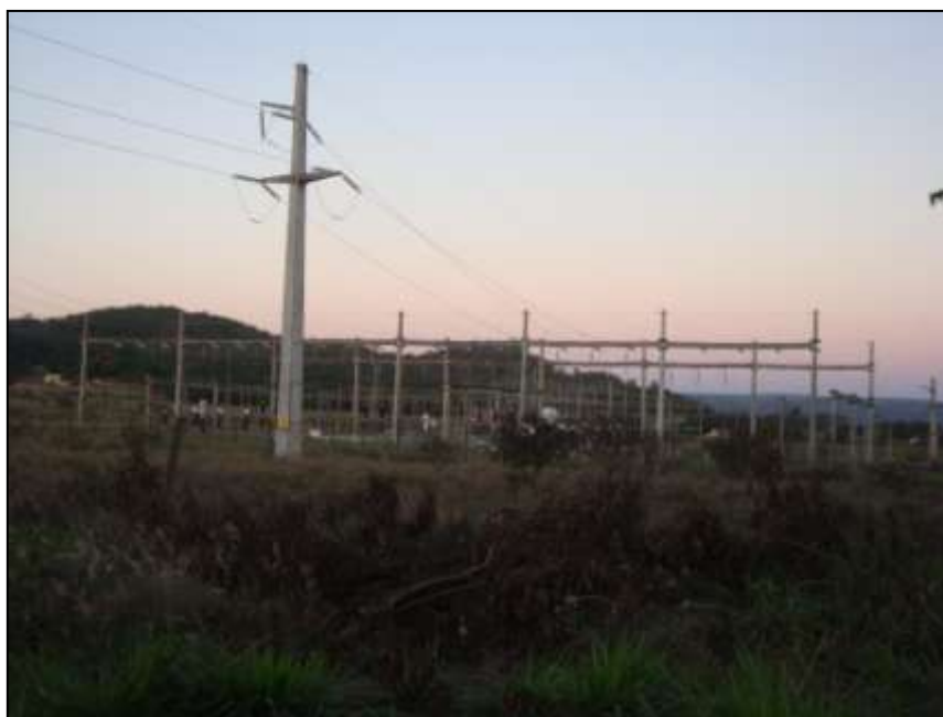
Foto 20: Subestação de Energia em Cachoeira Alta/GO
