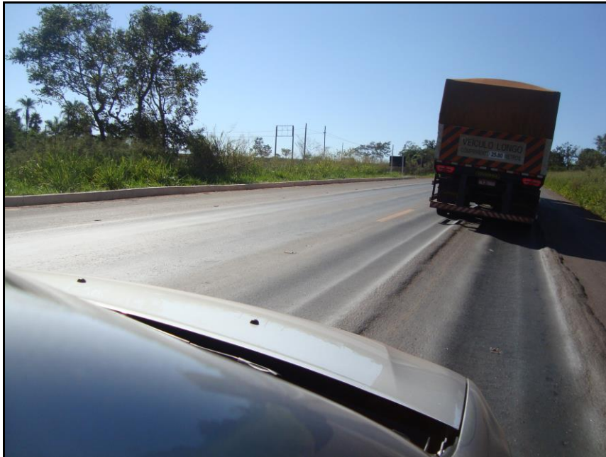
Foto 3: Deformação do pavimento e escorregamento lateral devido peso excessivo de cargas - BR-364/GO. Fonte: STE Engenharia
