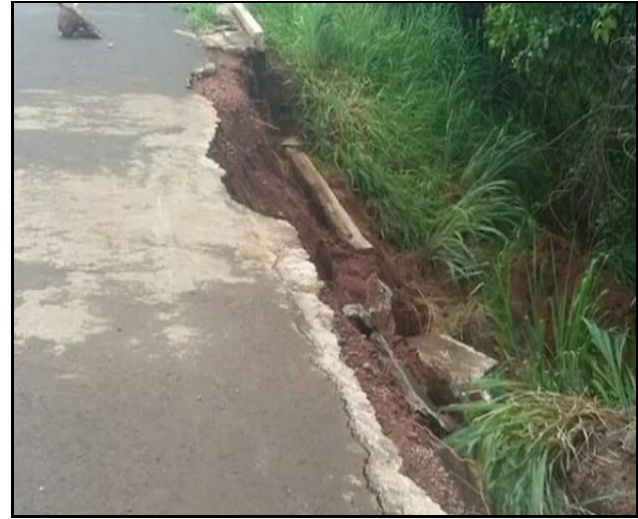
Foto 2 - Deslizamento do Talude do Corpo estradal , km 22 - BR-364/GO - Paranaiguara/GO
