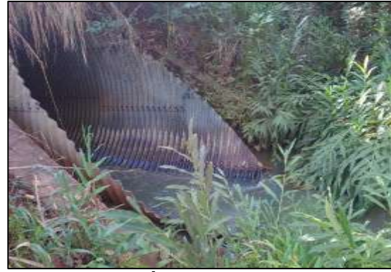
Figura 157. Córrego na rodovia BR-365.
