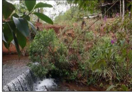
Figura 11. APP degradada na faixa de domínio.
