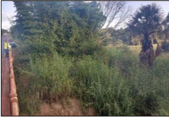
Figura 84. Ponte sobre o Córrego Cachoeira Alta na faixa de domínio da rodovia.
