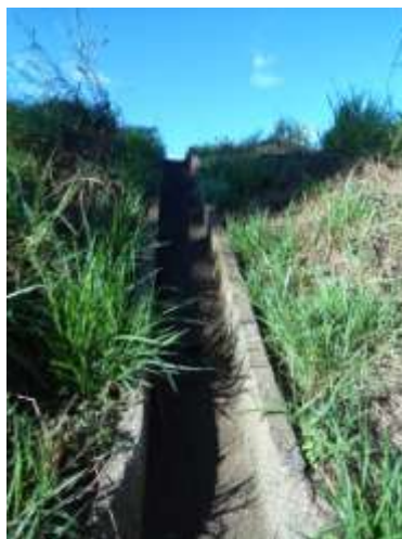
Foto 87 - Sistema de drenagem a montante.
