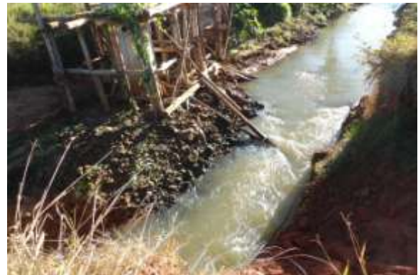
Foto 132 - Calha do rio estrangulada por fundação da ponte.
