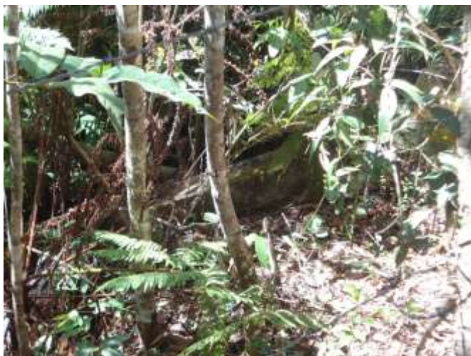
Foto 129 – Galeria de drenagem da AHS.
