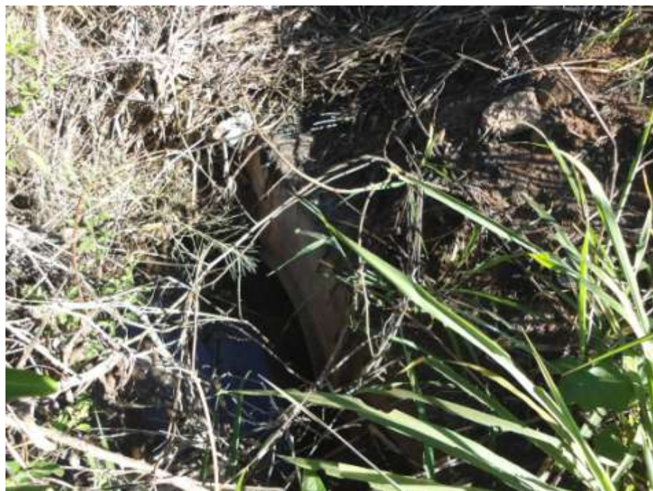
Foto 98 – Bueiro de ligação da AHS com o outro lado da rodovia.
