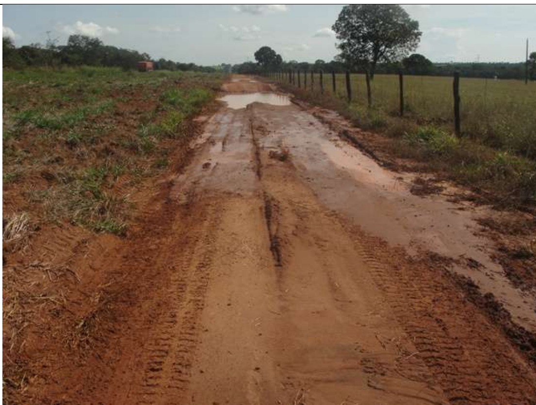
Foto 65– Nitossolo com fração argilosa que dificulta a percolação do solo. Município de Ituiutaba/MG.
