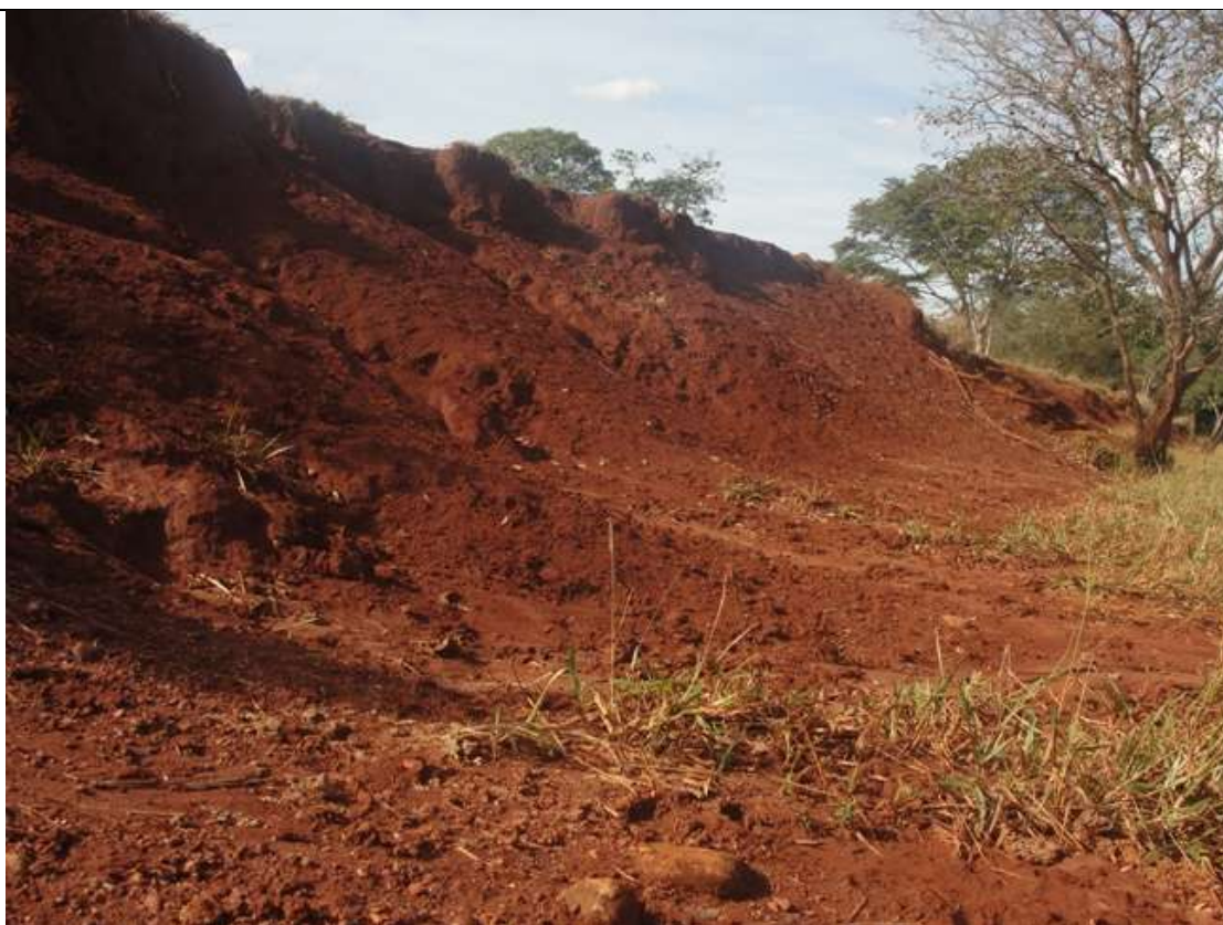
Foto 51– Processo erosivo iniciado pela falta de conservação do talude. Município de Santa Vitória/MG.
