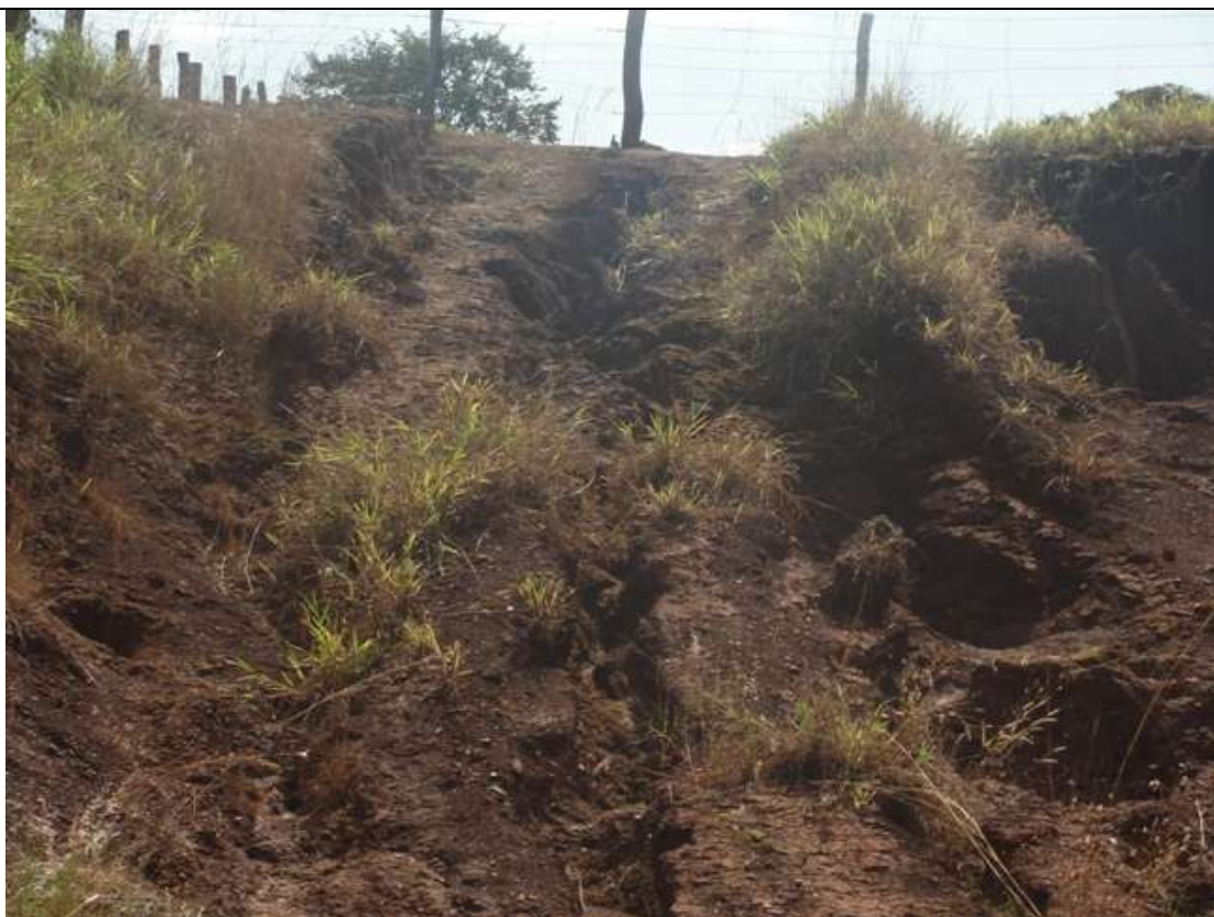
Foto 48 – Processo erosivo iniciado pela retirada da vegetação no talude. Município de Ituiutaba/MG.
