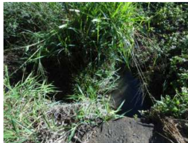
Foto 88 - Sistema de drenagem a jusante.
