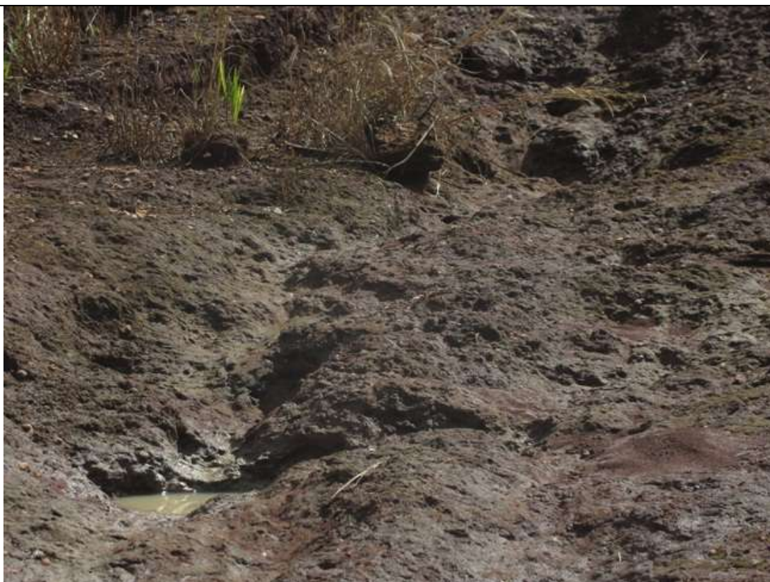
Foto 50– Processo erosivo iniciado pela retirada da vegetação no talude. Município de Ituiutaba/MG.
