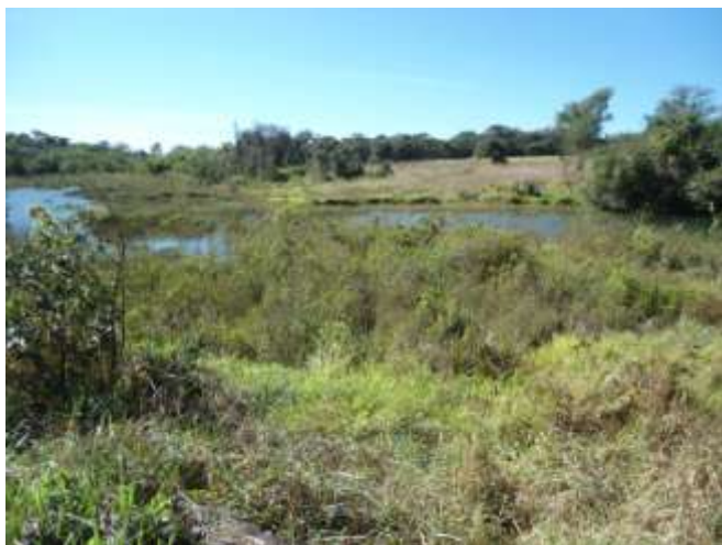
Foto 102 – Bueiro de ligação da AHS com o outro lado da rodovia.
