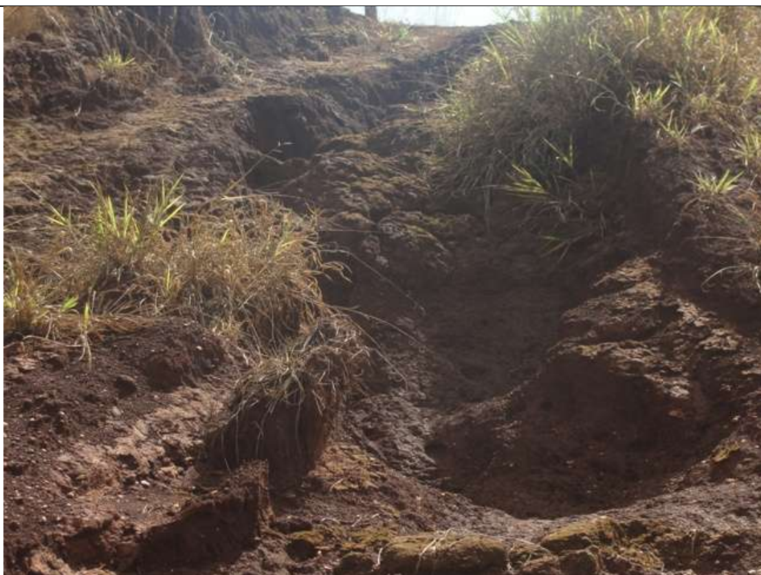
Foto 49– Processo erosivo iniciado pela retirada da vegetação no talude. Município de Ituiutaba/MG.
