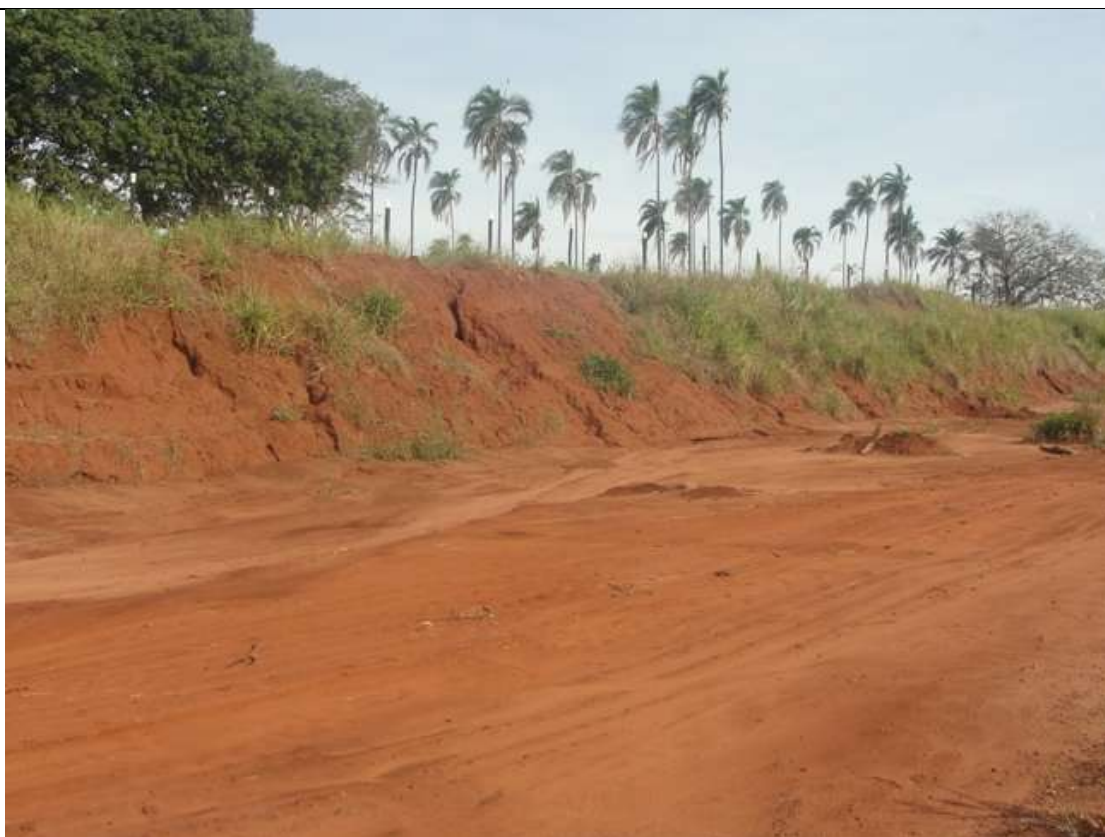
Foto 53– Processo erosivo iniciado pela falta de conservação do talude. Município de Santa Vitória/MG.
