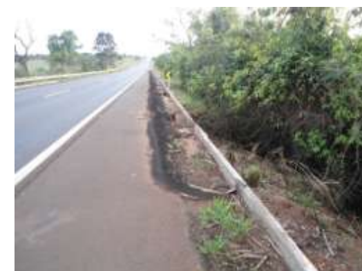
B – Vista a jusante da AHS da vegetação e asfalto cedendo.
