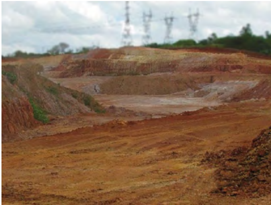
Desestabilização de encosta/talude.
