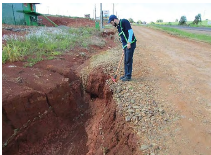
Erosão às margens da rodovia.
