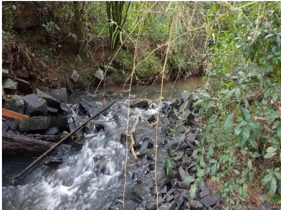
Figura 137 - P-17 (Arroio Porto) à Montante da Ponte de Intersecção com a BR-386/RS
