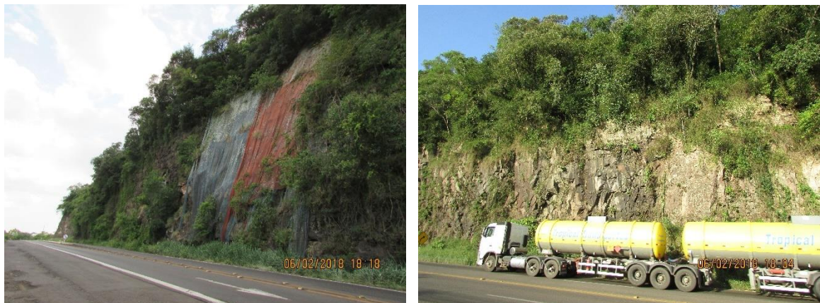
Figura 100 - Lonas utilizadas para mitigar os efeitos de possível desprendimento de blocos de rocha de talude alto subvertical na região serrana, próximo à ponte sobre o rio Fão.
