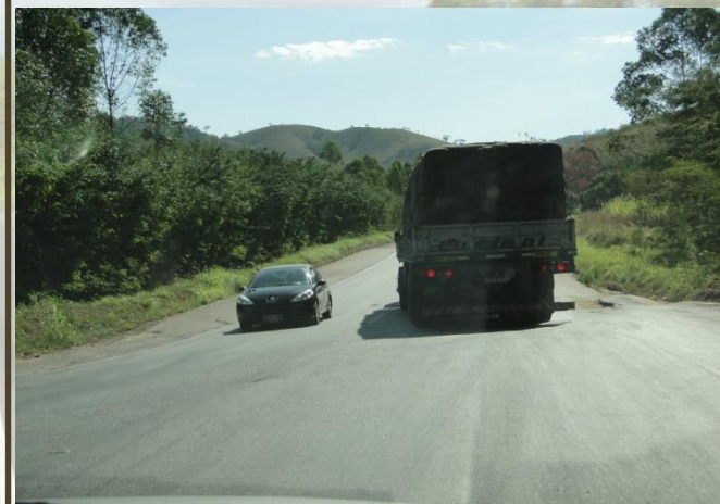
Flagrante de risco devido afundamento de via (Fervedouro/MG). Foto: Equipe STE.
