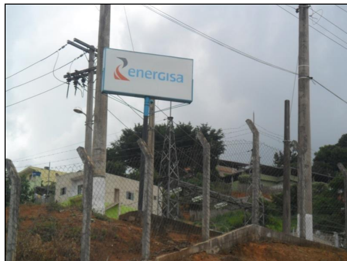
Foto 11: Subestação da ENERGISA em Laranjal/MG.
