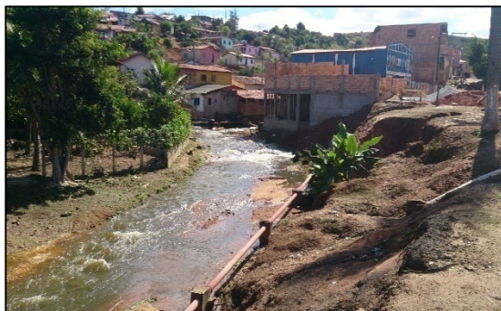
Figura 103 - APP 25 totalmente alterada, sem presença de vegetação localizado em área urbana da rodovia BR-116/MG.
