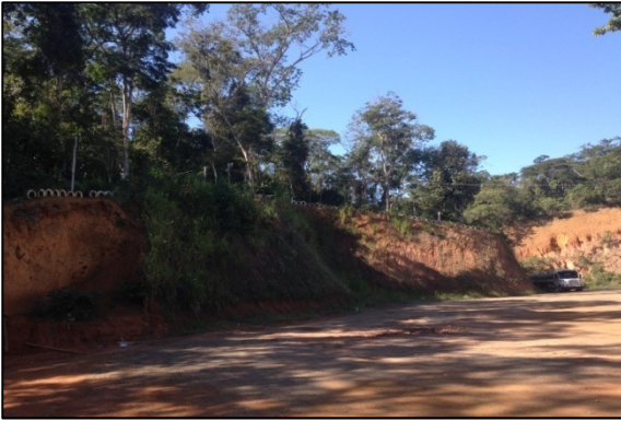
Figura 98 - Fragmento aonde foi alocada a parcelas FES 1 com suseptibilidade aos processos erosivos, localizado na rodovia BR-116/MG.
