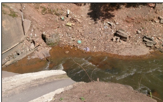
Figura 104 - APP 25 totalmente alterada, sem presença de vegetação, com o solo totalmente exposto, localizado em área urbana da rodovia BR-116/MG.
