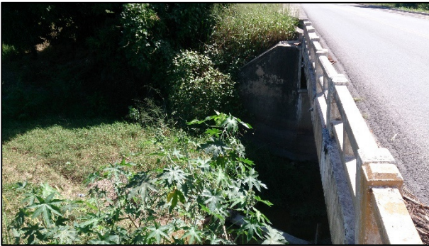
Figura 86 - APP 15 totalmente degradada, localizada na rodovia BR-116/MG, somente capim e espécies invasoras.
