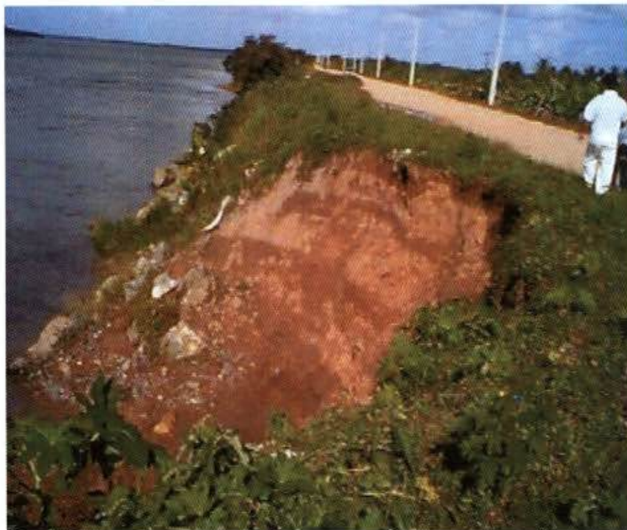
Figura 60: Trecho erodido no Dique do Serrão do PI de Betume, no município de Ilha das Flores.
