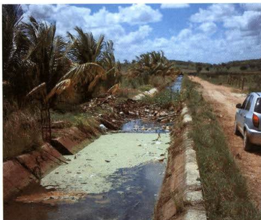
Figura 54: Restos de cultura e resíduos sólidos obstruindo a passagem de água no canal de irrigação.
