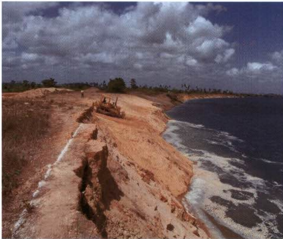
Figura 51: Foto das obras de reparo do dique de contenção às margens do rio São Francisco.
