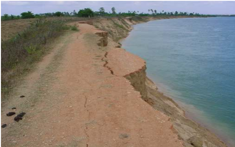
Figura 22: Dique de contenção, do Serrão em situação precária.
