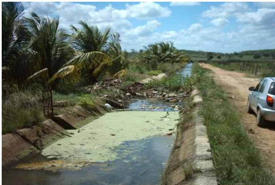
Figura 21: Restos de cultura e resíduos sólidos obstruindo a passagem de água no canal de irrigação.
