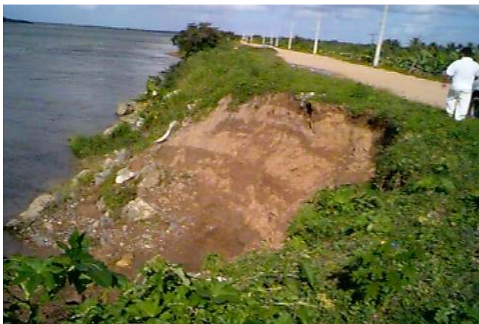
Figura 27: Trecho erodido no Dique do Serrão do PI de Betume, no município de Ilha das Flores.
