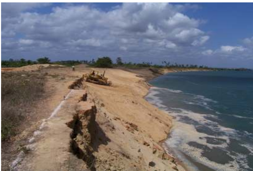
Figura 23: Obras de reparo do dique de contenção às margens do rio São Francisco.
