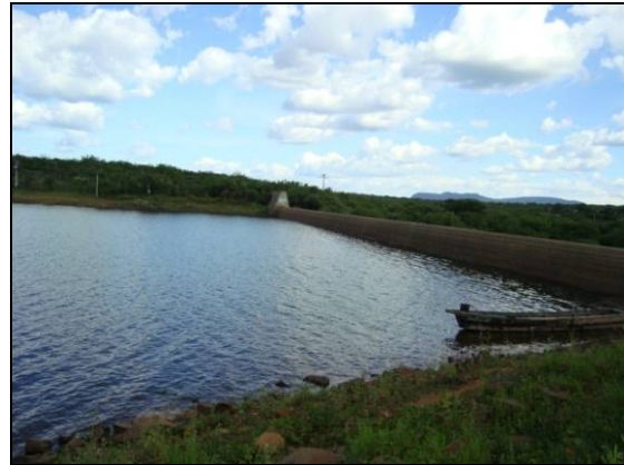
Foto 02: Eixo da barragem do Reservatório Terra Nova, no município de Terra Nova-PE.
