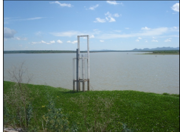
Foto 02: Eixo da barragem do Açude barra de Juá próximo ao município de Airi - PE.
